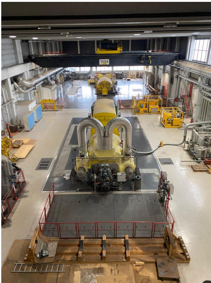
Kuva 9. Martinlaakson voimalaitoksen turbiinisali.
