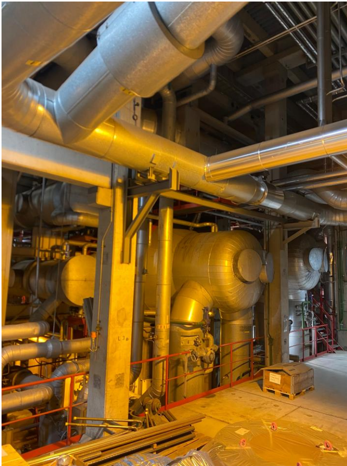
Kuva 11. Turbiinirakennus 2:n ensimmäinen kerros.
