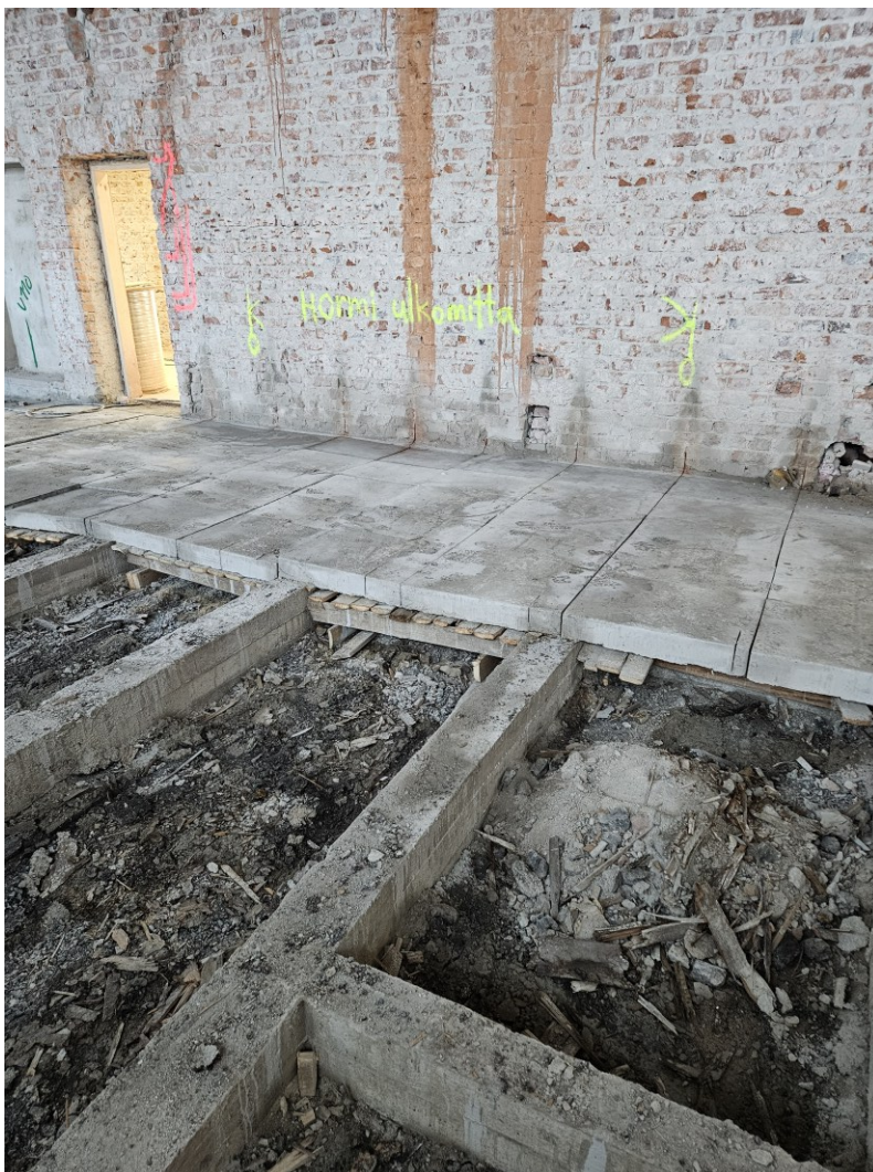
KUVA 3. Ylälaatta poistettu osittain ja palkkiväleissä koksikuonaa. (Pätsi 2024.)
