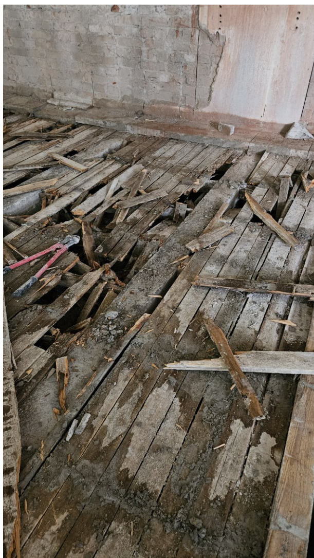
KUVA 5. Kosteusvaurioituneita muottilautoja (Pätsi 2024.)
