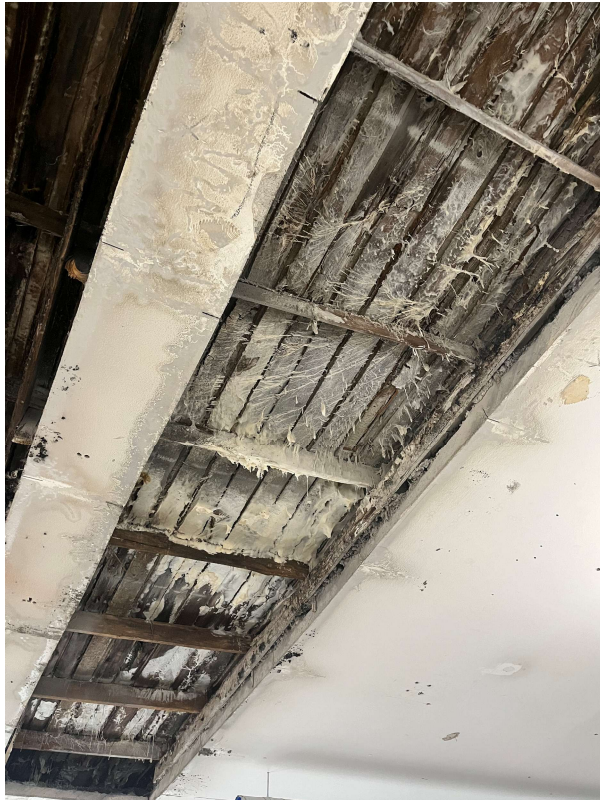
KUVA 5. Vaurioituneet muottilaudat avatun välipohjan sisällä. (Kuva: Eeli Mikola)
