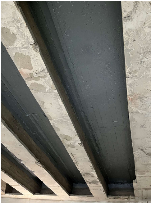
KUVA 15. Ylälaatan alapinta kapseloituna. (Kuva: Eeli Mikkola)
