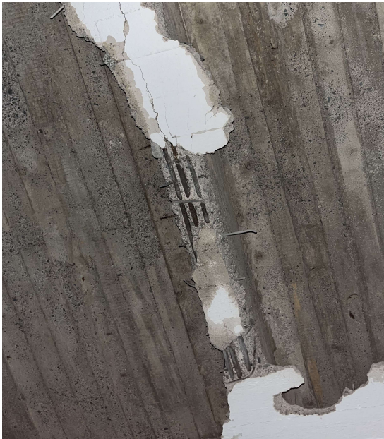
KUVA 11. Palkin alapinnan teräks näkyvissä. (Kuva: Eeli Mikkola)
