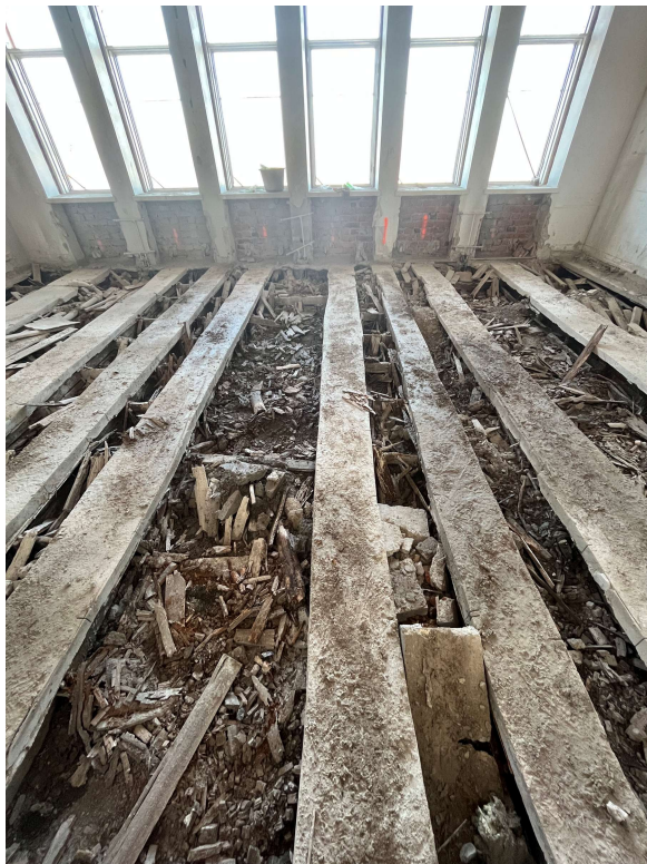
KUVA 6. Kaksoislaattapalkiston ylälaatta sahattu auki. (Kuva: Eeli Mikkola)
