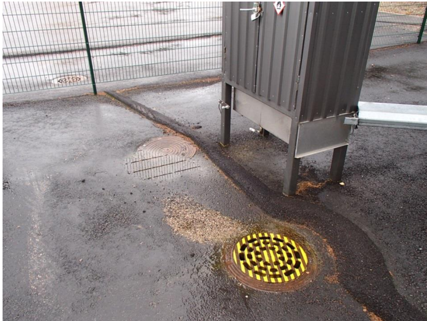
Kuva 19. Öljynerotuskaivo ja sadevesijuoksut
