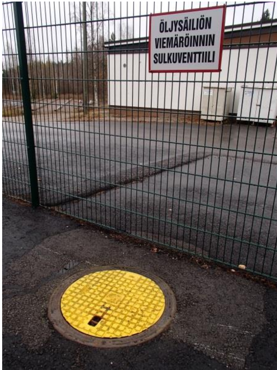
Viemäröinnin sulkuventtiili ja kilpi
