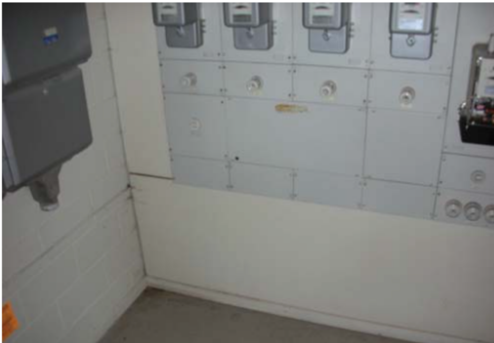
Kuva 6. Sähkökaapin taustalevytyksenä on käytetty asbestisementtilevyä [23.]
