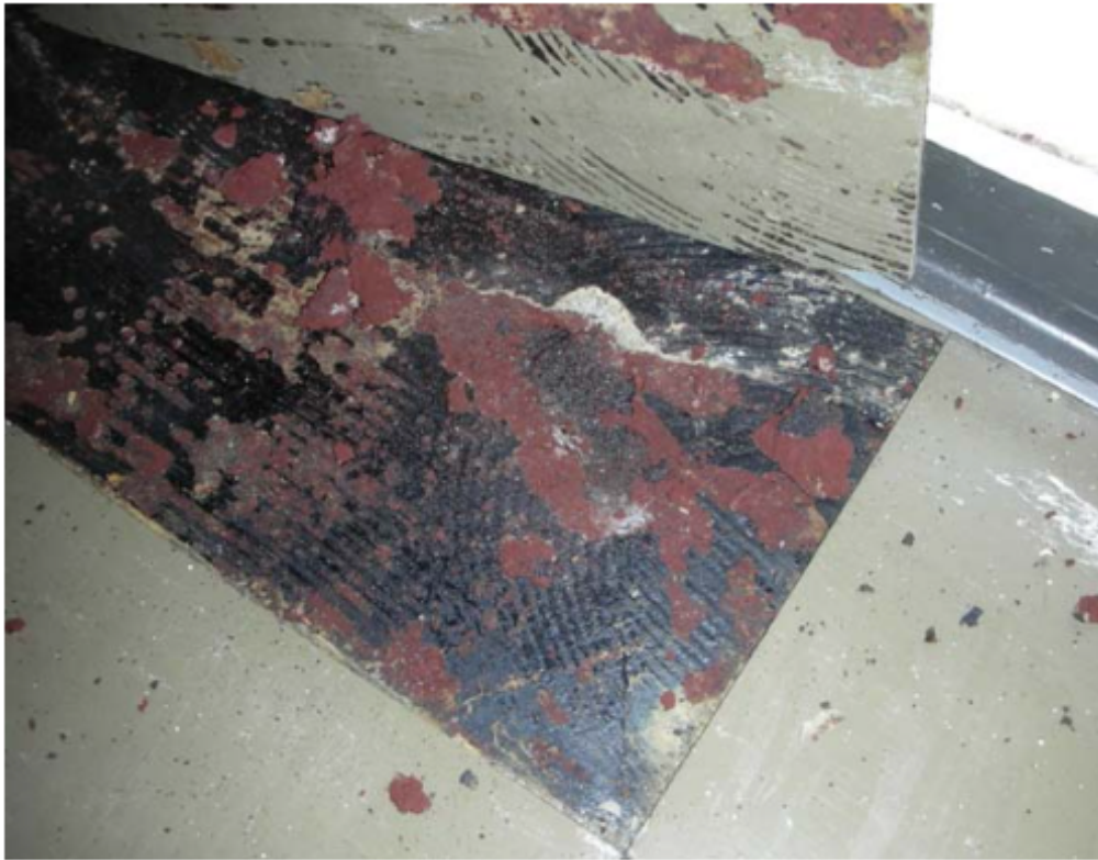
Kuva 8. Pohjakerroksena asbestipitoisen vinyylimaton alla on ruskea valuasfalttikerros. Matto on liimattu alustansa mustalla bitumiliimalla
