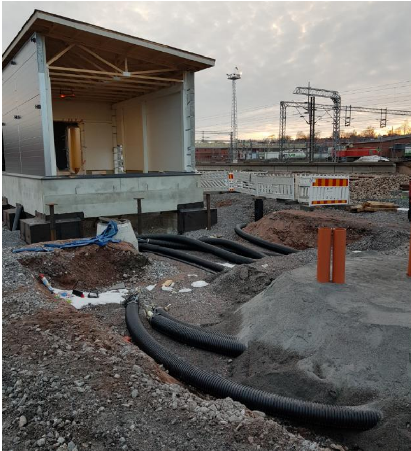
Kuva 26. Eristetyt alueputket huoltorakennuksen kohdalla [3].
