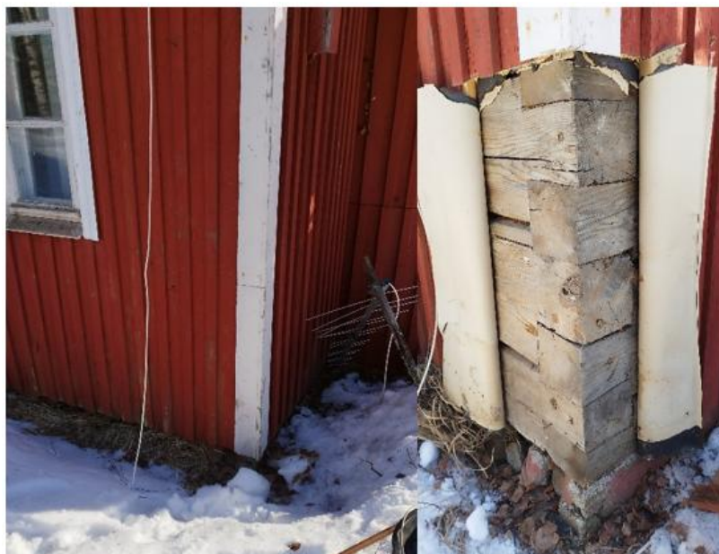
Kuva 19. Vaurioitunut hirsinurkka ulkopuolelta (Koponen 2025, CC BY-SA)
