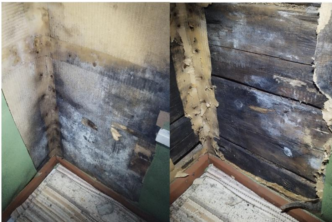
Kuva 18. Vaurioitunut hirsinurkka (Koponen 2025, CC BY-SA)
