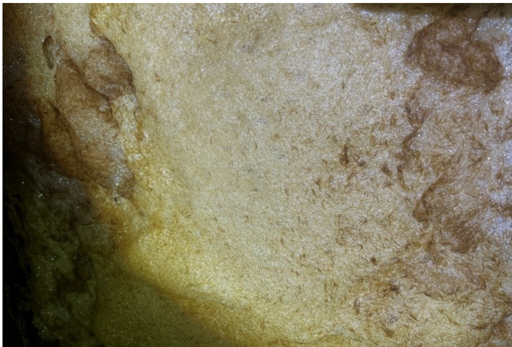
Kuva 11. Vaahdon aiheuttama kuituhäviö jätevesikanaalissa.
