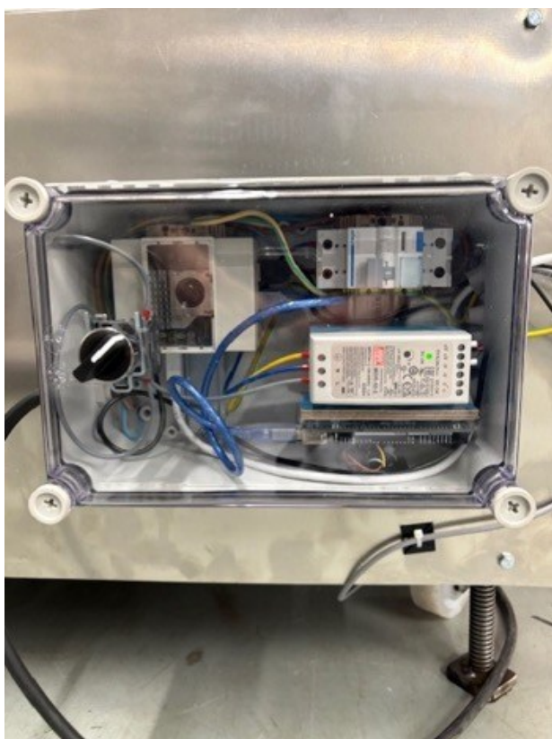
Kuva 13. Sähkökotelo laitteen perässä.
