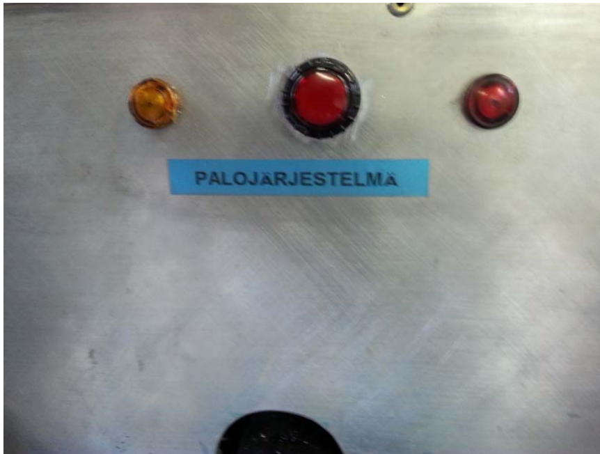
Kuvio 16. Sammutusjärjestelmän merkkivalo asennettuna kojetauluun.
