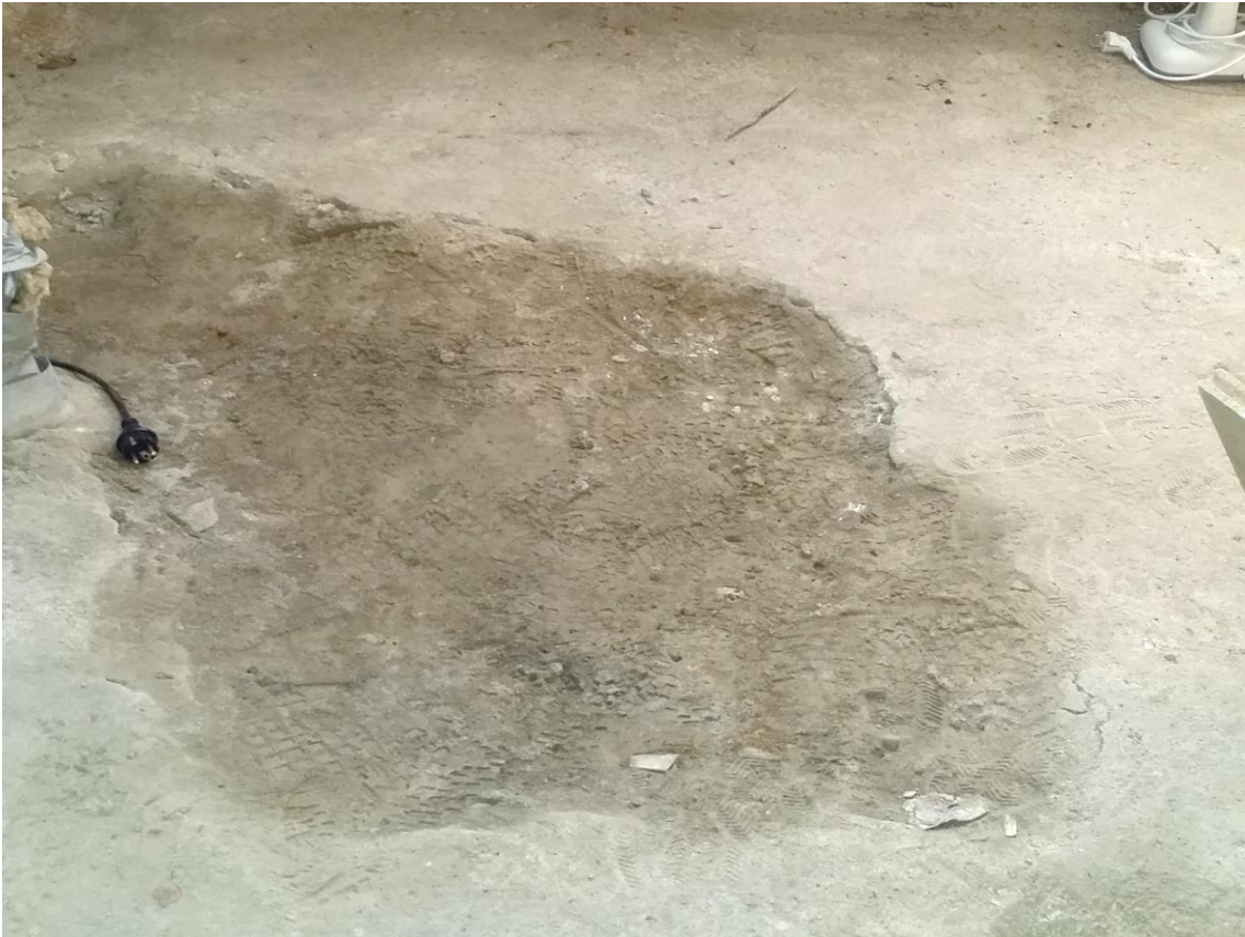
KUVA 4. Murtunut kellarin lattia
