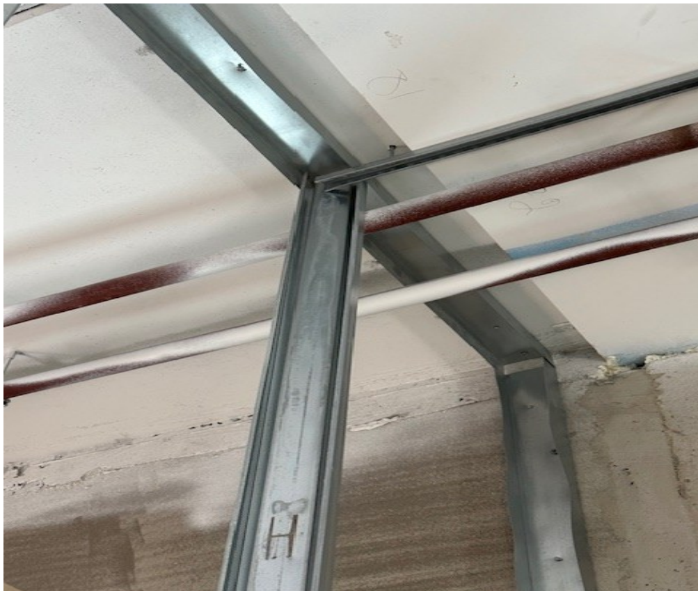
Kuvio 22. Rankajakoa jouduttiin muuttamaan talotekniikan takia.
