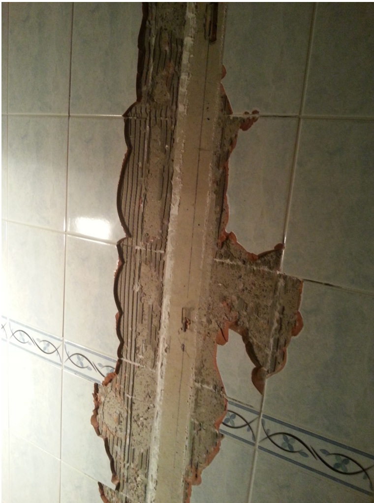
Kuva : Vanhan välioiven karmien takaa ei löytynyt vedeneristystä
