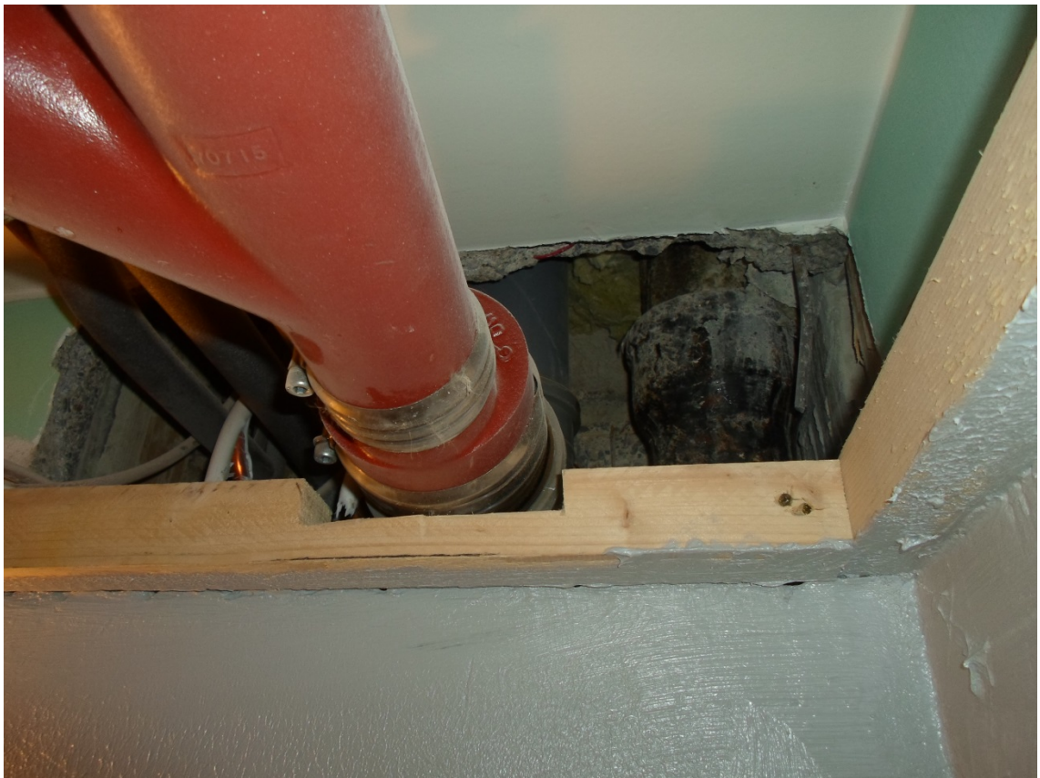
Kuva: Hormi sivusta päin kuvattuna
