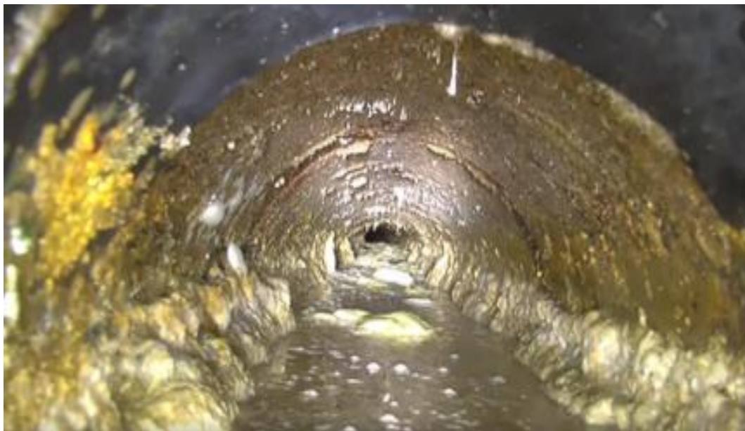
Kuva 14. Saostuma putkessa (mukailtu Ojala & Kuikka 2021)
