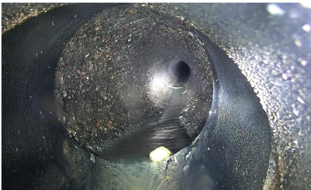
Kuva 12. Syöpynyt betoniputki (Aqua Palvelu Oy)
