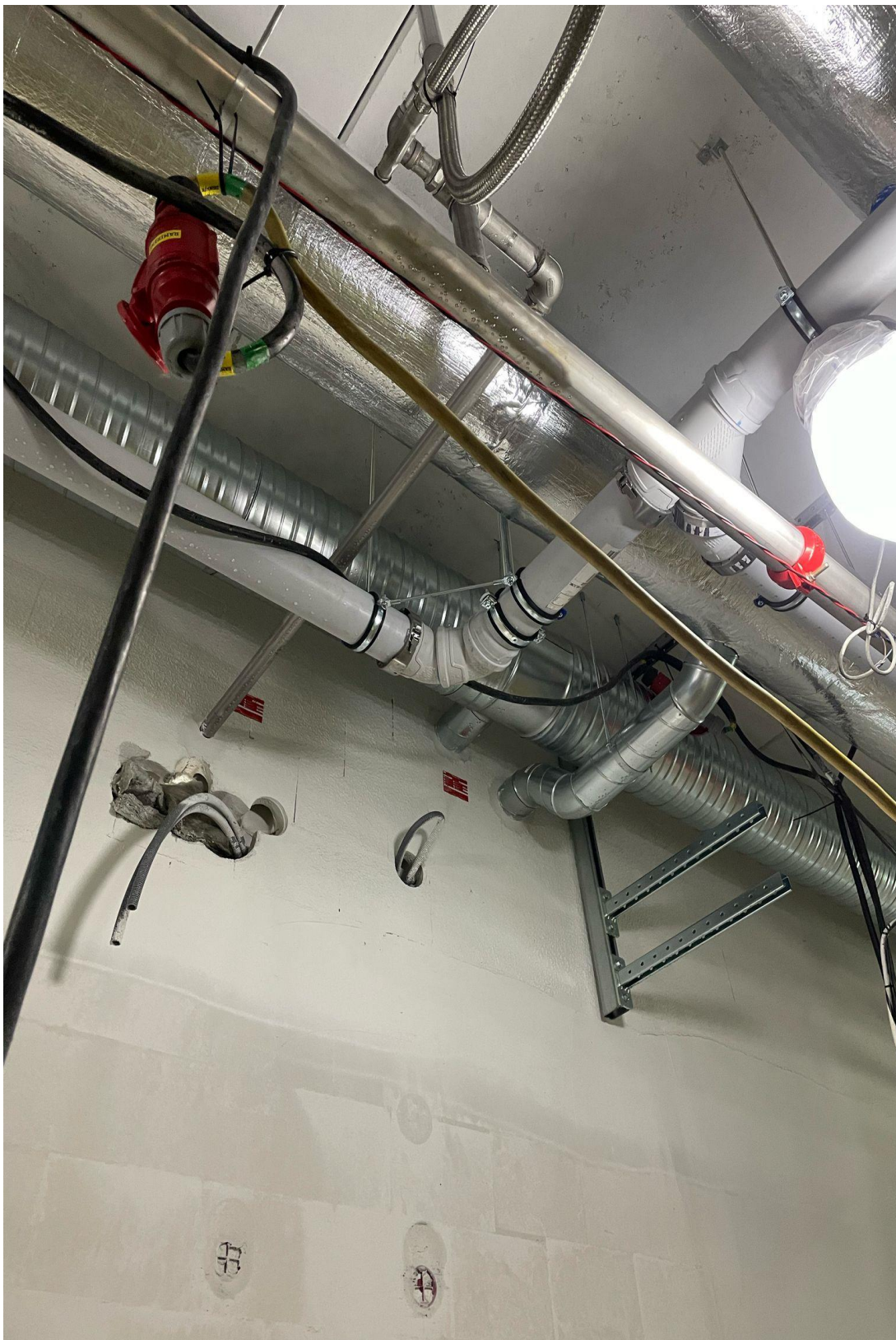
Kuva 16. Sadevesiviemäreiden toteutus näytti tältä ennen painekoetta. Kyseisessä kohdassa kulmayhteet irtosivat toisistaan painekokeen aikana aiheuttaen vesivahingon ja lisää työtä. [18]
