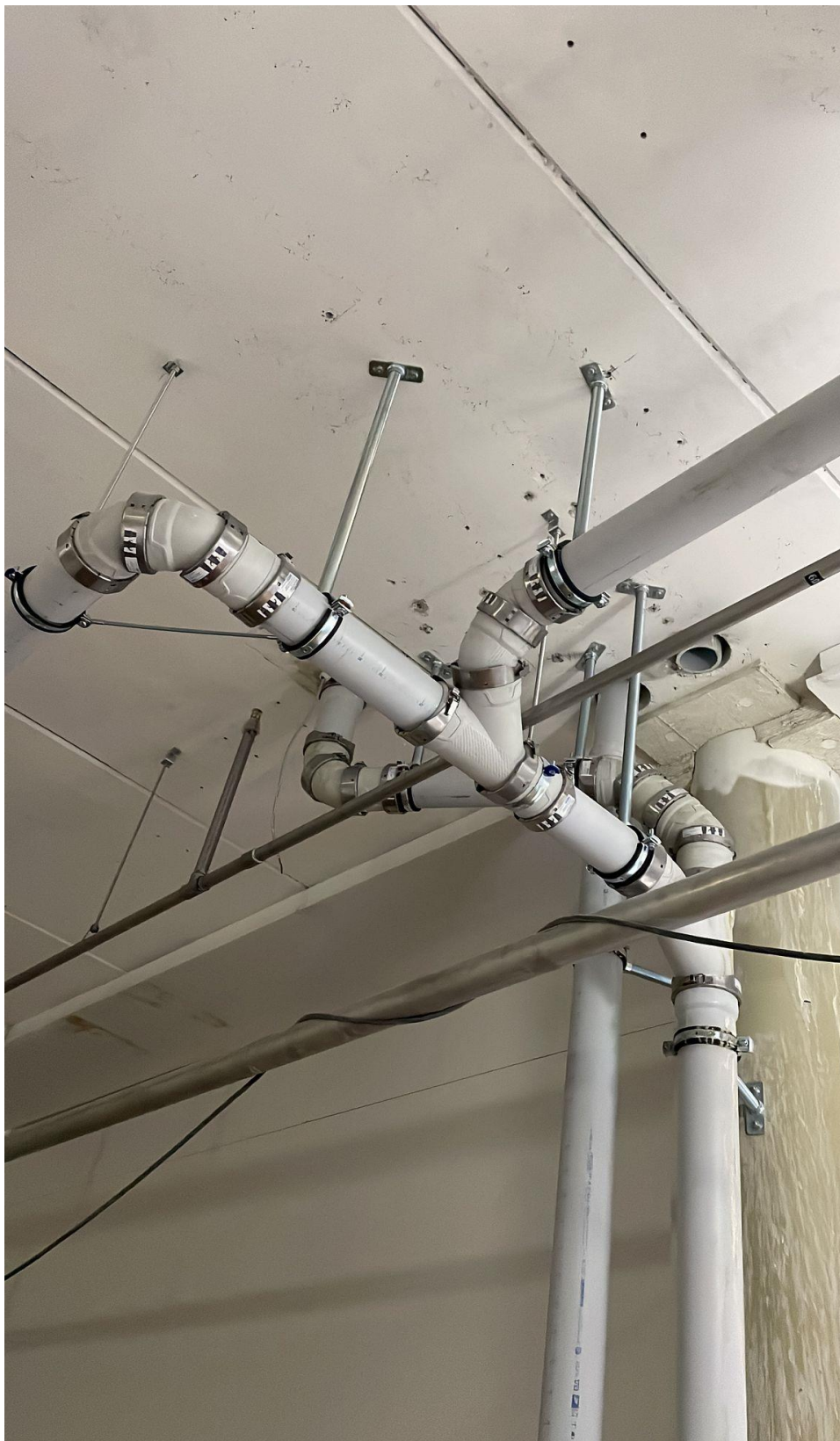
Kuva 17. Virheistä opittuna sadevesiviemärihajotuksiin lisättiin kuvan osoittamalla tavalla selvästi jykevempi kannakointi, vedonpoistoa viemäriosien välille sekä lukituspantoja muhviilitoksiin [18].
