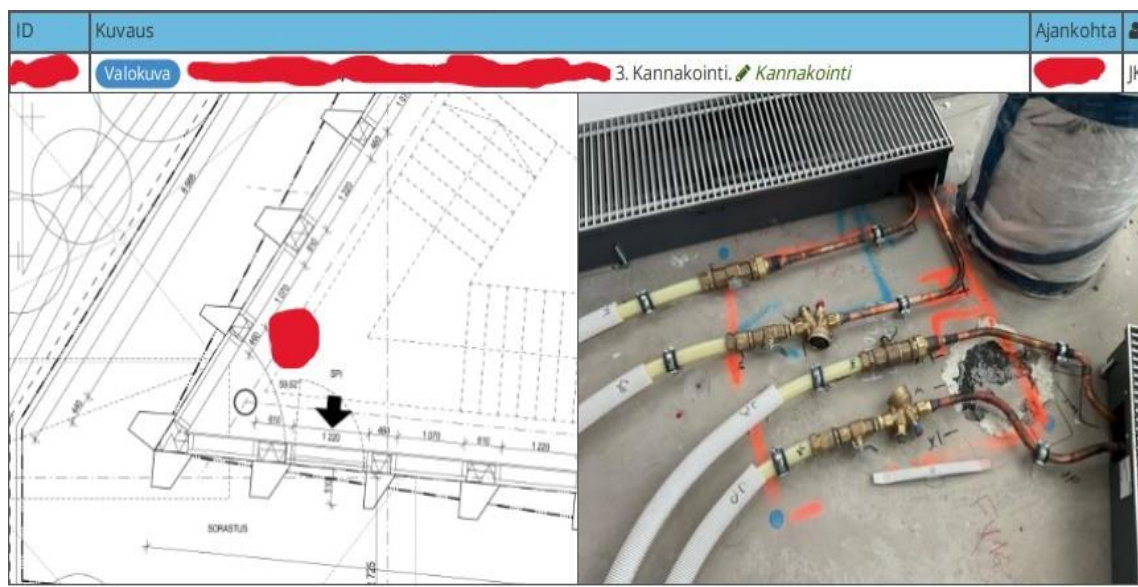
Kuva 9. Congrid-dokumentti lämmitys- ja jäähdytysjärjestelmän piiloon jäävistä putkiasennuksista omassa tarkastuspositiossaan [10].
