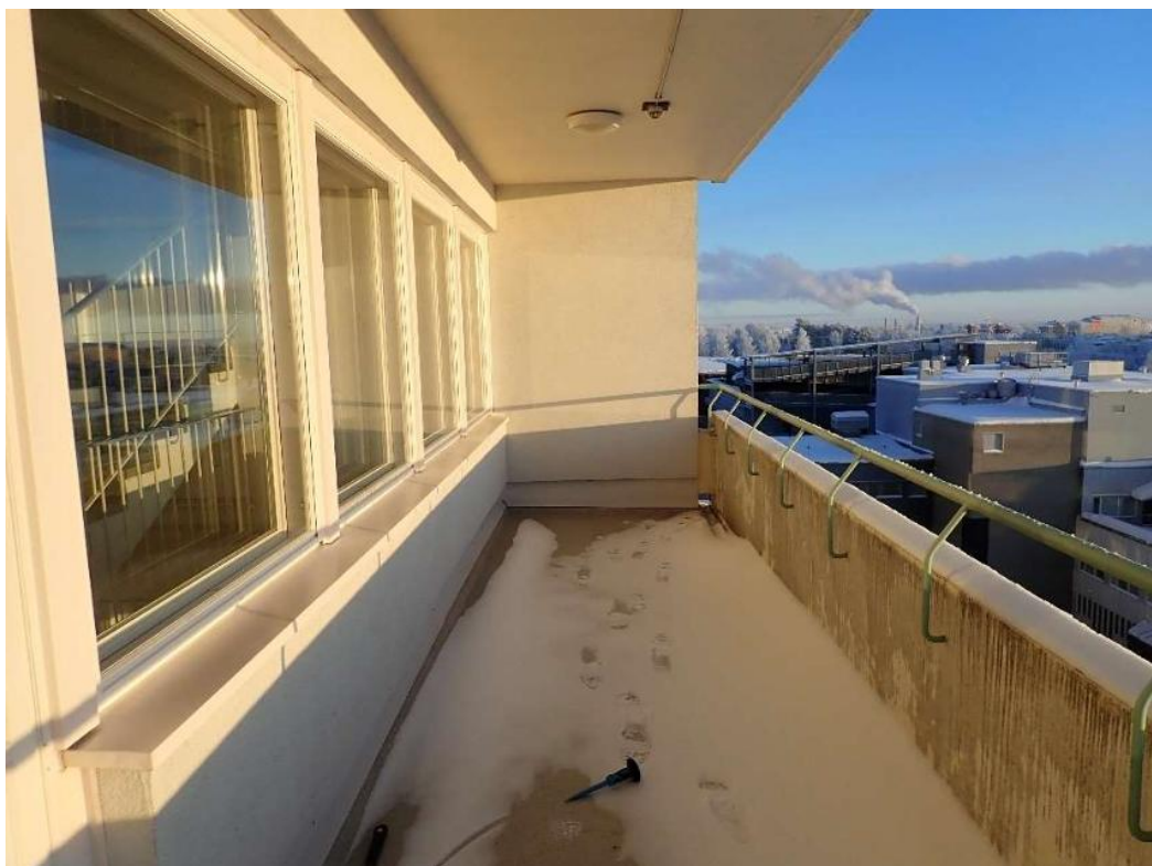
Kuva 6. Eteläpuolen parveke (korjaustyöselostus 2023)
