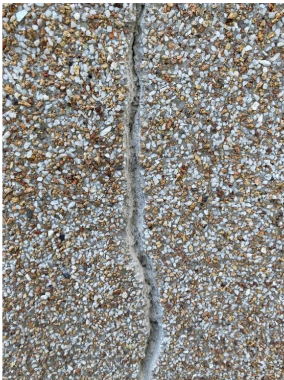
Kuva 8. Auki piikattu halkeama (Matilainen 2024)
