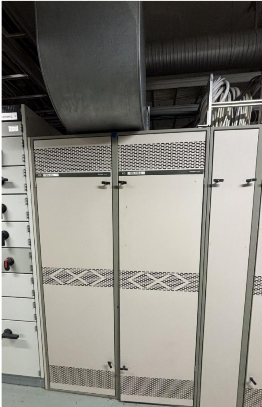
Kuva 25. RK180-1 ja ilmastointikanava
