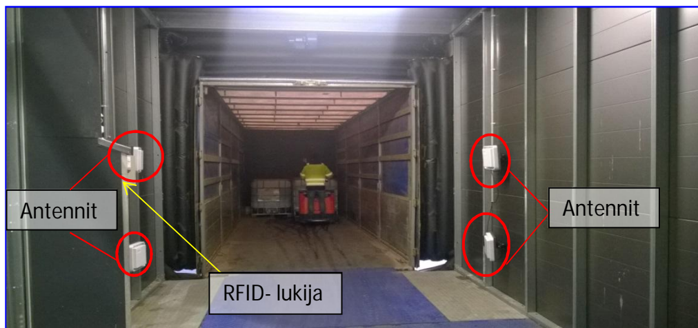
Kuvio 11. Lastauslaiturille asennettiin RFID- antennit sekä lukija
