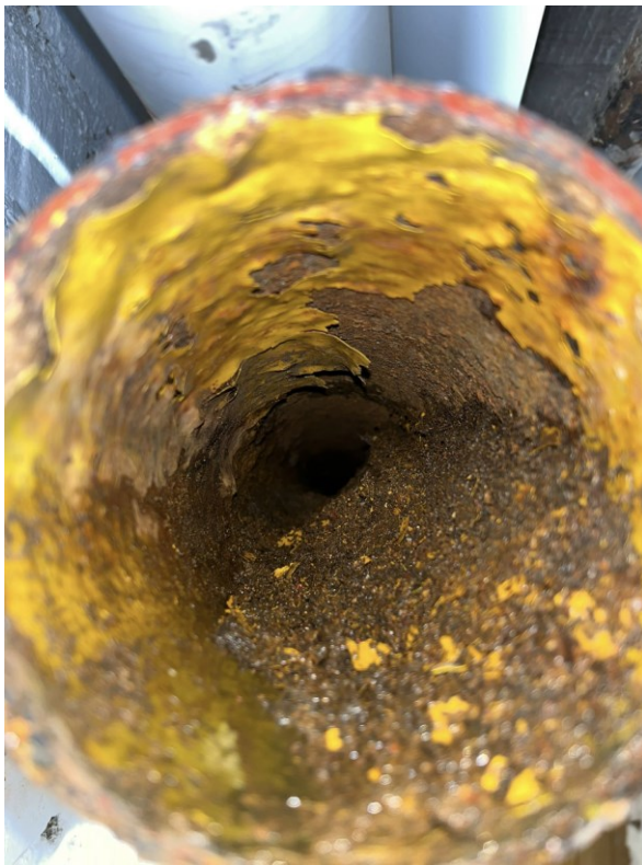
Kuva 3. Viemäriä ei ole puhdistettu kunnolla.
