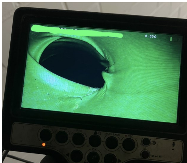
Kuva 1. Epäonnistunut asennus, johtuen haarayhteen asennusvirheestä.
