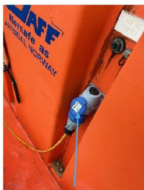
Koppla ur laddkabeln och förvara den på "crew deck"
