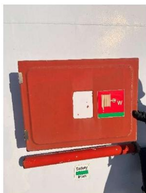
Förråd för brandslang
