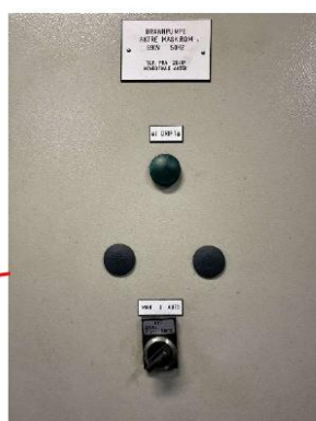
Panel för brandpump med indikeringslampor
