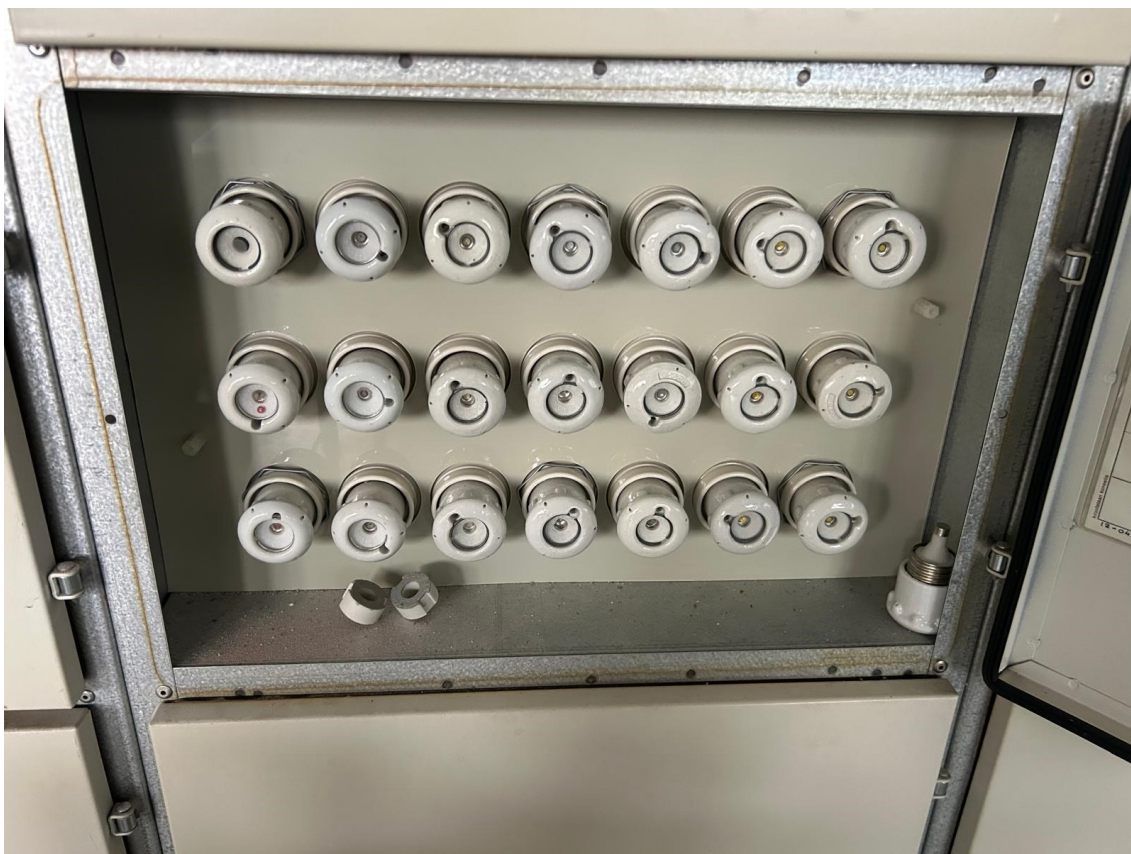
Kuva 27. Sähkökeskuksen sisällä säilöttyä tavaraa
