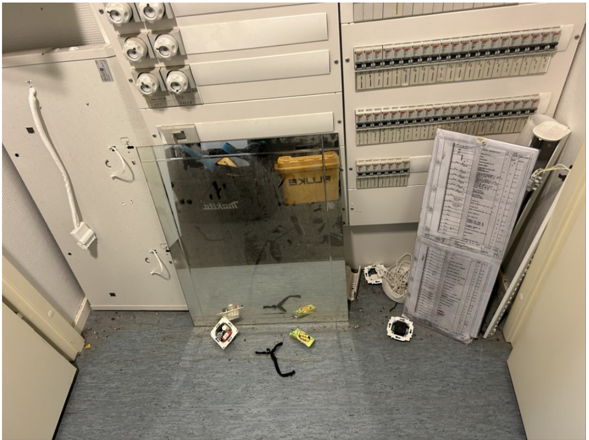
Kuva 14. Sähkökeskuksessa ollutta sinne kuulumatonta tavaraa
