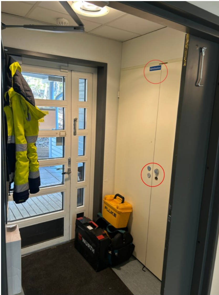
Kuva 13. Sähkötila kuvattuna ulkoapäin
