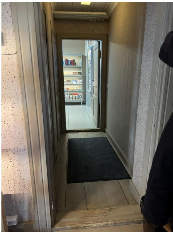
Kuva 12. Rakennus 2, lipunmyynnin eteisen kynnysten tasoerot (Holopainen 2025, CC BY)
