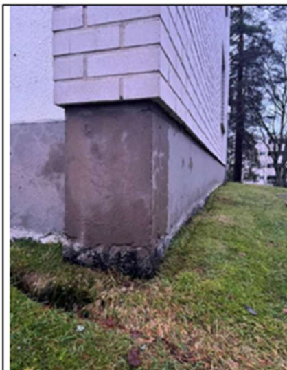
Kuva 9 Sokkelin alapinnassa on havaittavissa vaurioita maanpinnan kosteuden takia. Sokkelissa näkyy lisäksi hiushalkeamia.
