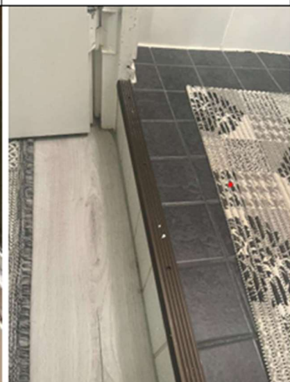
Kuva 49 Huoneiston 13 pesuhuoneessa ei ollut määräysten mukaista kynnystä.
