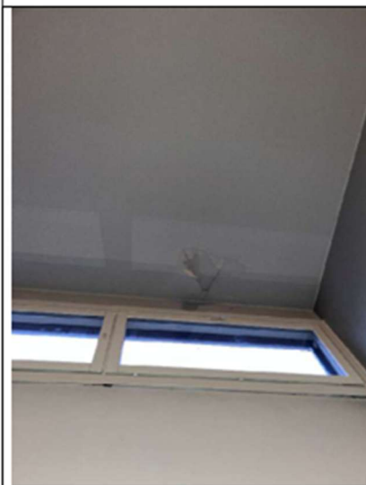
Kuva 27 Porrashuoneen katon maalipinta on vaurioitunut.
