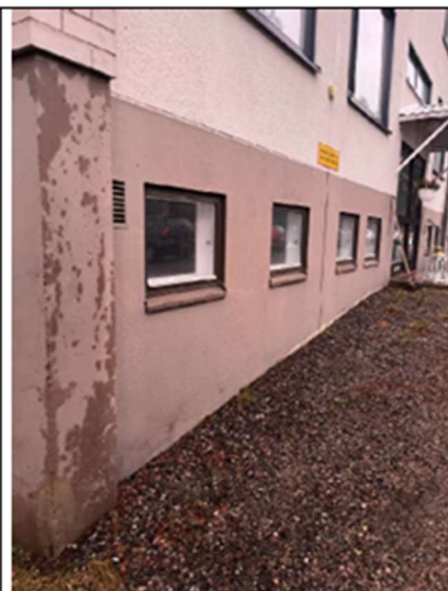
Kuva 10 Maanvastaisien seinien sekä ympäröivän maan välissä ei näy patolevyä.
