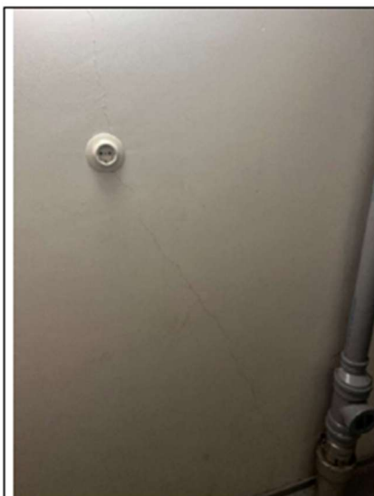
Kuva 17 Kellarikerroksen seinässä laaja halkeama.
