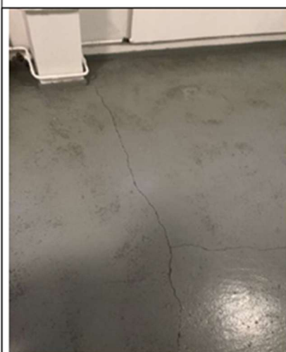
Kuva 13 6-talon kuivaushuoneen lattian pinnoitteen halkeama.
