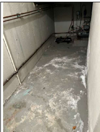
Kuva 15 F-rapun portaiden alla olevassa tilassa lattia on laajasti vaurioitunut kaivon tulvimisen seurauksena.
