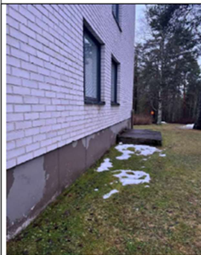
Kuva 7 Nurmialueiden kaadot 6-talosta pois-päin ovat puutteelliset pohjoispäädyssä.
