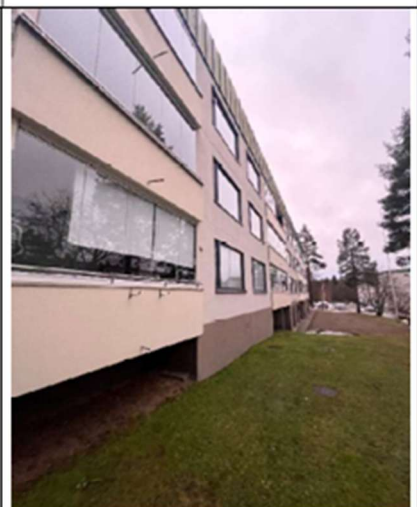
Kuva 8 Nurmialueiden kaadot 6-talosta pois-päin ovat puutteelliset myös takapihalla.
