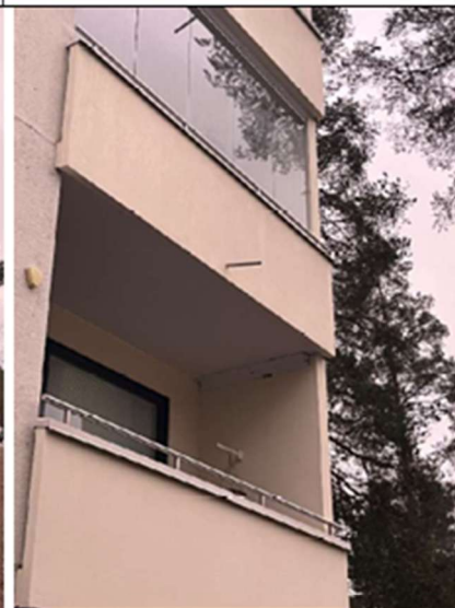
Kuva 22 Yhden parvekkeen yläsauma on lohkeillut ja siihen on asennettu metallinen levy.
