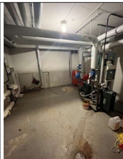
Kuva 16 Lämmönjakuhuoneen lattia on kulunutta ja halkeamaista.
