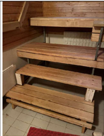
Kuva 33 Saunan lauteet ovat halkeilleet päädystä.
