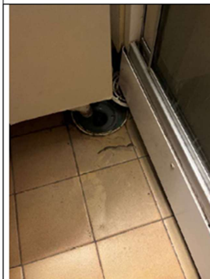
Kuva 48 Huoneiston 35 viemäri on hankalasti puhdistettavissa, eikä vedä hyvin.
