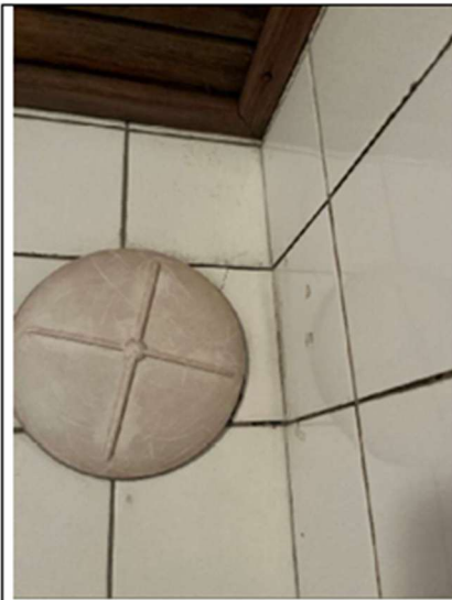
Kuva 32 Ilmanvaihtokanavan vierellä laatta haljennut.
