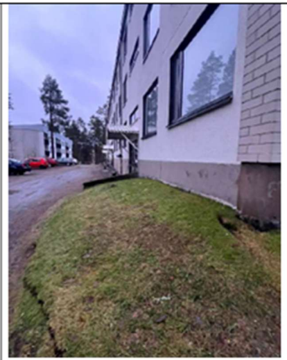
Kuva 2 Nurmialueessa on paikoittain huonokuntoisia kohtia. 4-talon etupihan kaadot rakennuksesta poispäin ovat hyvät.
