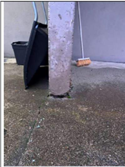
Kuva 5 Asfaltin pinnassa näkyvillä halkeilua 4-talon autotallien edustalla.
