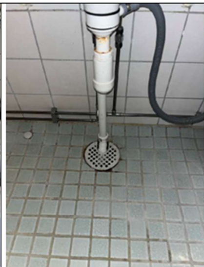
Kuva 47 Kaivot ovat muovisia.
