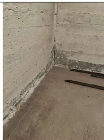
Kuva 18 Väestönsuojan maanvastaisen seinän ja alapohjan liitoksessa viitteitä kosteudesta.
