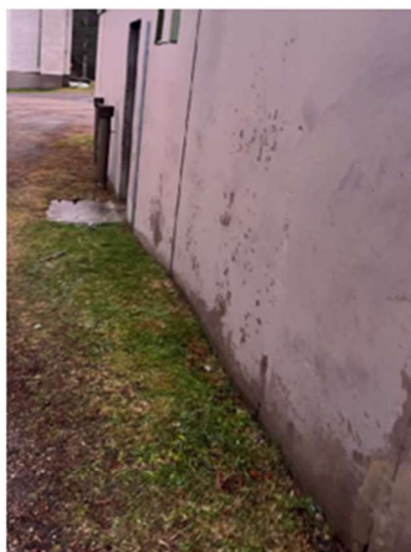
Kuva 11 Kostealla kelillä huomataan, kuinka maanvastaisen seinän alaosa kerää paikoin kosteutta kaatojen puutteellisuuden vuoksi.
