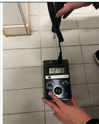
Kuva 12 4-talon pesutilan lattiassa on viitteitä kosteudesta.
