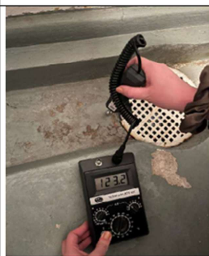
Kuva 14 6-talon pyykkituvan kaivon ympärillä lattian pinnoite vaurioitunut ja pintakosteus on koholla.
