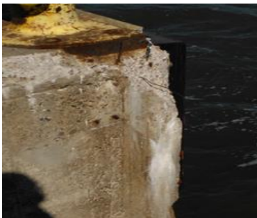
Kuva 13. Laituri 9, tankkerin törmämisestä aiheutunut vaurio,
