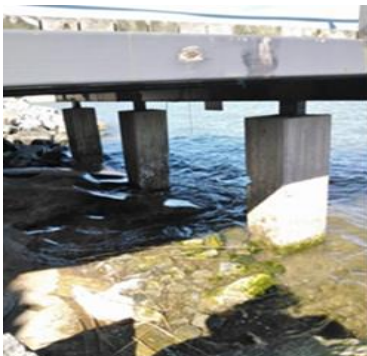
Kuva 14. Laituri 9, Veden ja jään rapauttamat pilarin alaosat.
