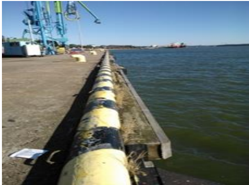
Kuva 12. Laituri 8, Vaurioitunut fenderi.
