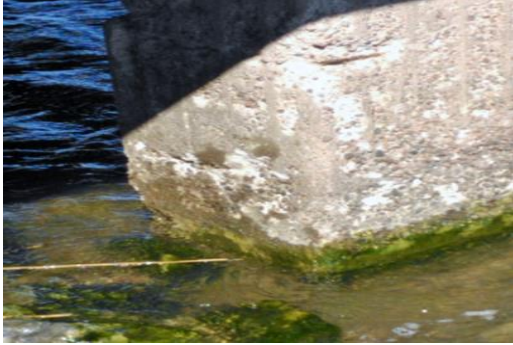
Kuva 10. Laituri 8, eroosio vaurio
