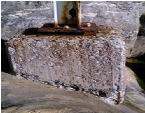
Kuva 9. Laituri 8, Korroosio vaurio
