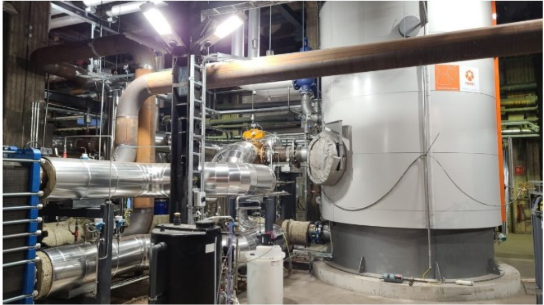
Kuva 7. Sähkökattila (EPV energia)
