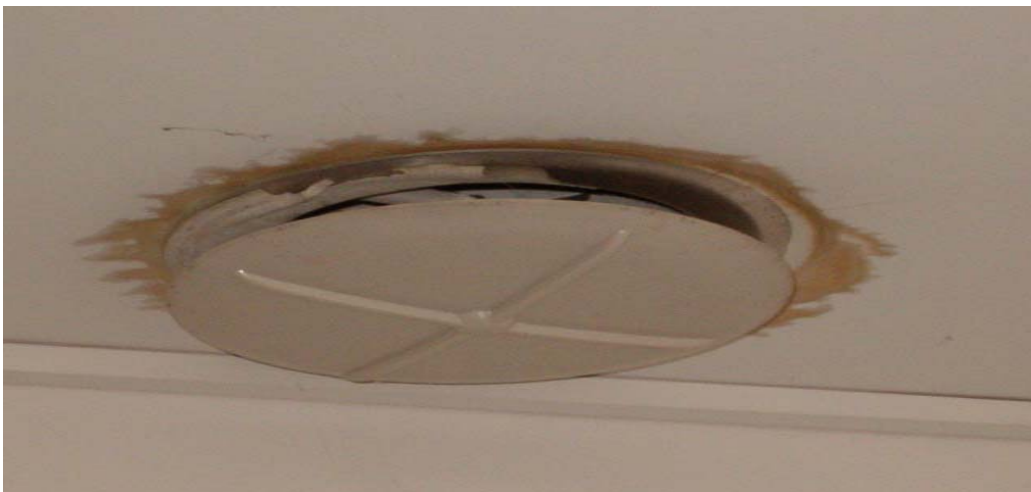
Kuva 24 (LVI-järjestelmien kuntoarvio). Osakkeen 1 vaatehuoneen poistoilmaventtiilin juuren kosteusjälki tulisi tarkemmin tutkia.
