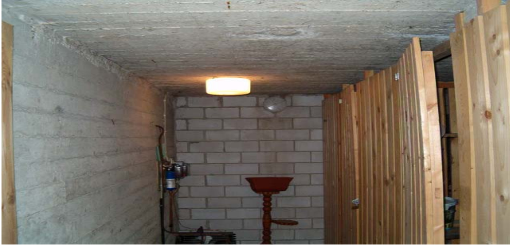
Kuva 16 (F6 Yleistilat). Varaston maalaamattomat, betoni ja KAH-tiili seinät tulisi maalata.
