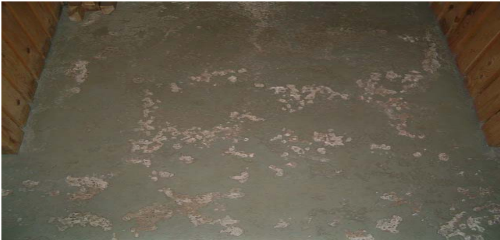
Kuva 17 (F6 Yleistilat). Varaston lattia tulisi tasoittaa ja maalata.
