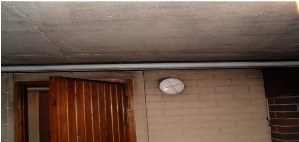
Kuva 20 (F6 Yleistilat). Askarteluhuone on runsaasti nokeentunut ja se kaipaa kokonaisuudessaan huoltotoimenpiteitä.
