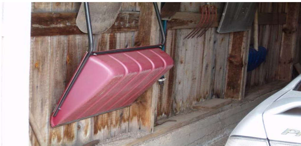
Kuva 13 (F42 Räystäät). Autokatoksen vanhempaan osaan tulisi rakentaa räystäät, ettei viistosade lahottaisi seiniä.
