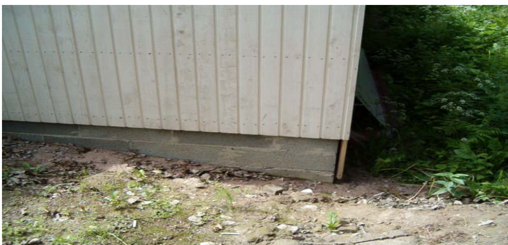
Kuva 5 (F1 Perustukset). Autokatoksen uuden osan perustukset tulisi pinnoittaa/eristää, kosteuden läpäisyn estämiseksi.
