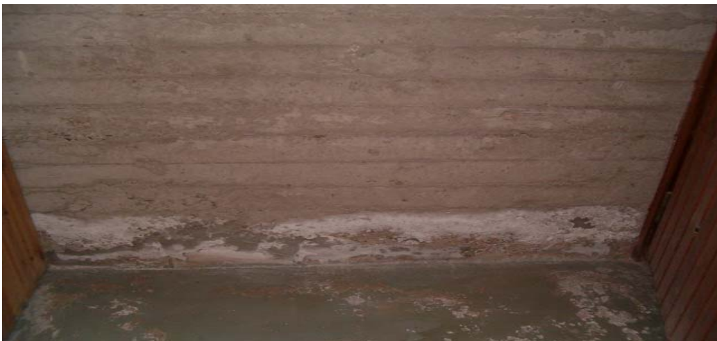
Kuva 18 (F6 Yleistilat). Varaston betoniseinät tulisi puhdistaa läpituulleesta kalkista ja maalata käyttötarkoitukseen sopivalla maalilla.
