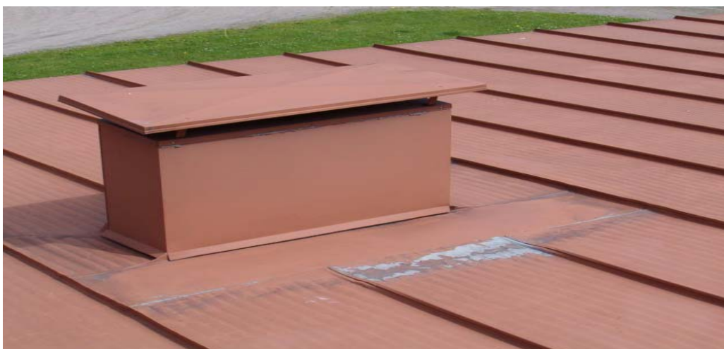
Kuva 12 (F41 Yläpohja). Asuinrakennusten vesikate tulisi huoltomaalata.
