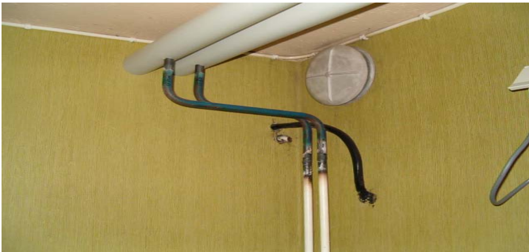
Kuva 23 (LVI-järjestelmien kuntoarvio). Lämpöpatterit ja niiden vesiputket kaipaavat huoltomaalausta asunnoissa ja yhteistiloissa.
