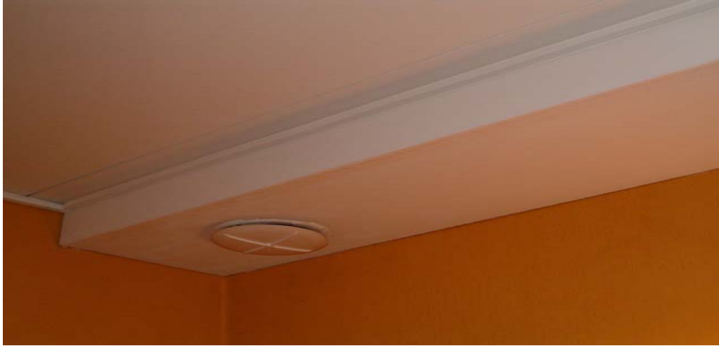
Kuva 25 (F7 Huoneistot). Osakkeiden 1, 4 ja 8 vesiputkien kotelointi tulisi tutkia tarkemmin, poistoilmaputkituksen osalta.
