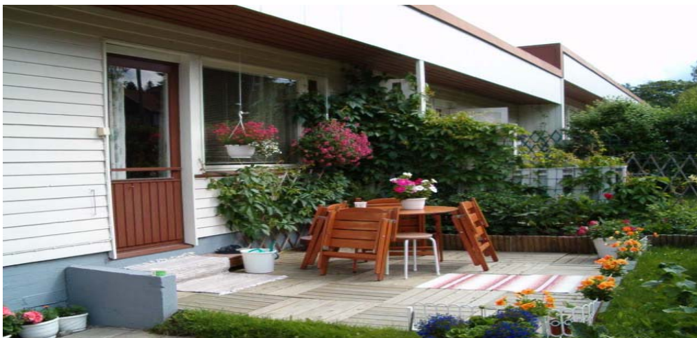
Kuva 1 (D6 Viherrakenteet). Liian lähellä rakennusten ulkoseiniä olevat istutukset tulisi poistaa, etteivät seinän puuosat lahoaisi.
