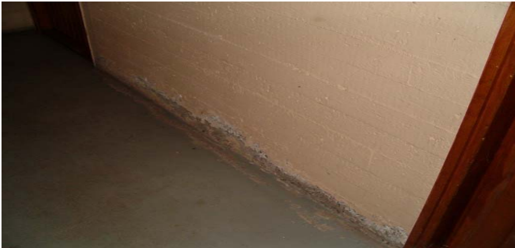
Kuva 19 (F6 Yleistilat). Käytävän seinien maalipinta on kulunut ja kalkki tullut läpi, myös seinät tulisivat huoltomaalata käyttötarkoitukseen sopivalla maalilla.
