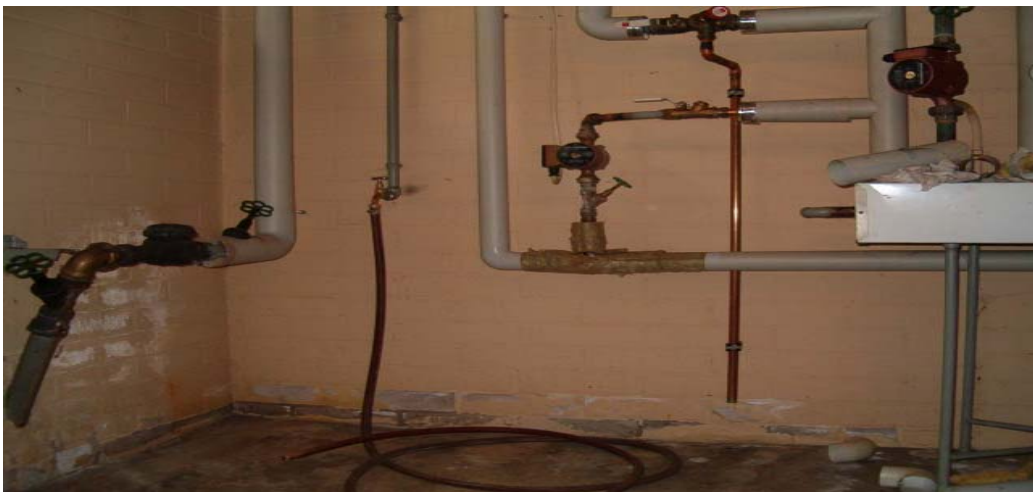
Kuva 21 (F6 Yleistilat). Pannuhuoneen lattia ja seinät ovat kuluneet ja ne tulisi huoltomaalata.
