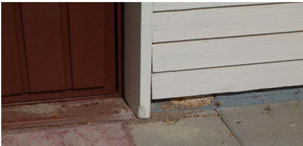
Kuva 4 (F1 Perustukset). Sokkeleiden paikalliset rapautumiset tulisi paikata ja huoltomaalata.
