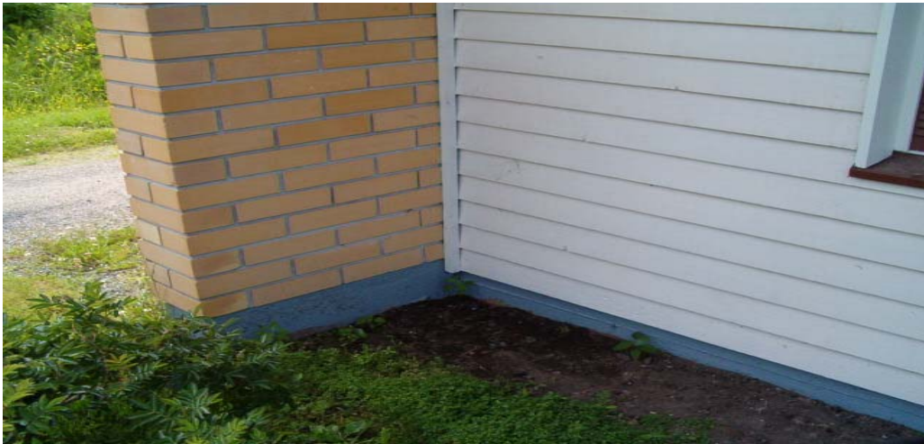
Kuva 8 (F31 Ulkoseinät). Matalasta sokkelista johtuen sivuseinien puuverhoilut ovat osittain liian lähellä maanpintaa.
