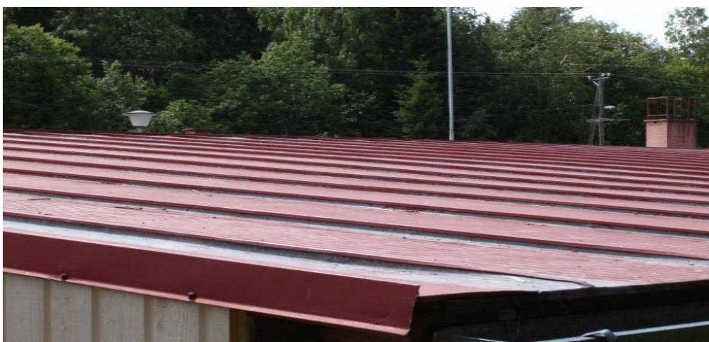
Kuva 2 (D9 Ulkopuoliset rakenteet). Autokatoksen vanhemman osan vesikate tulisi huoltomaalata.
