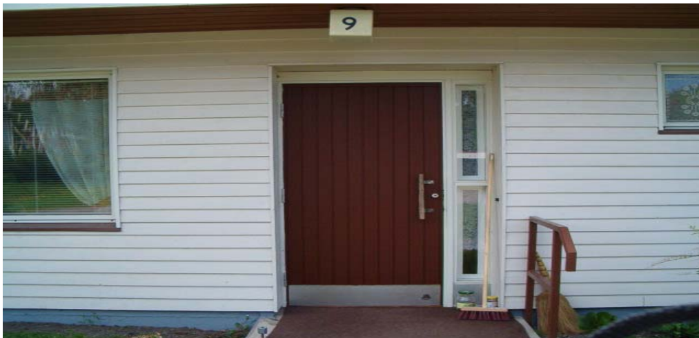
Kuva 10 (F33 Ulko-ovet). Alkuperäiset ulko-ovet tulisi myös vaihtaa toiminnallisesti ja lämpöteknisesti parempiin.
