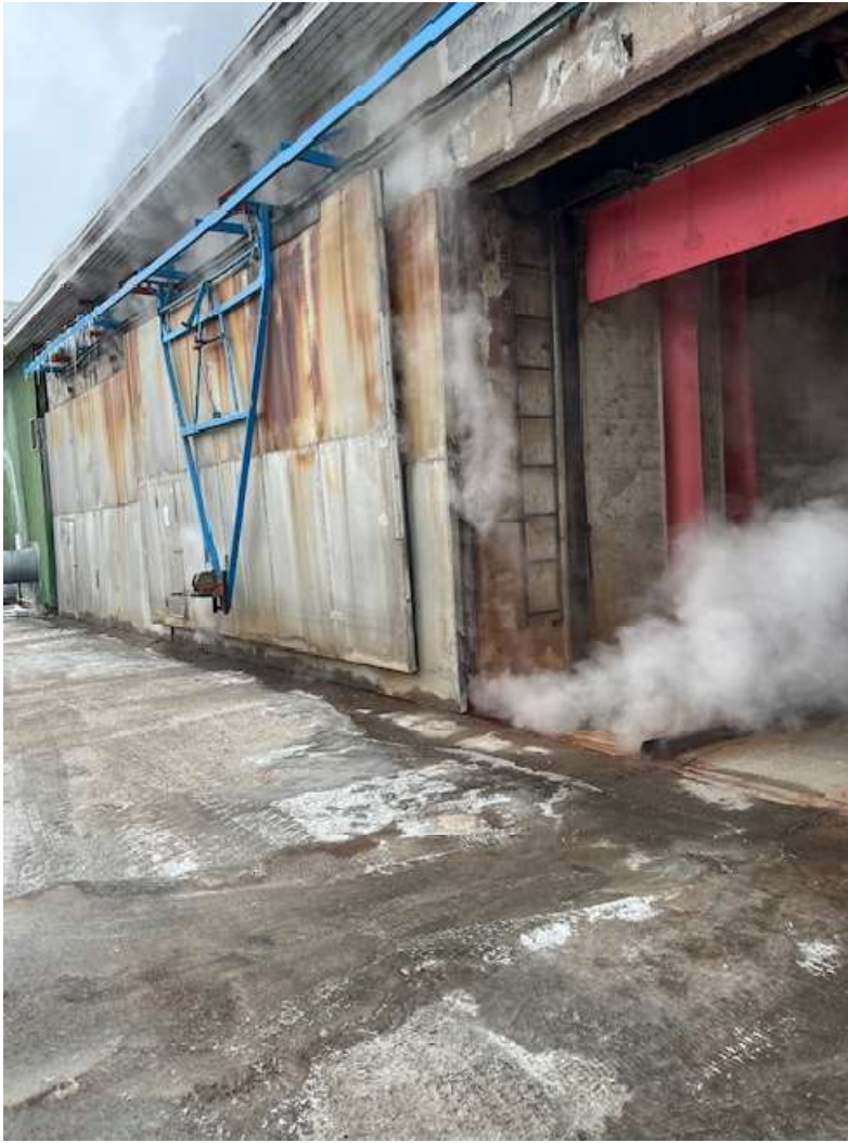
Kuva 7. Kamarikuivaamon poistoilman vuotoa 2. kamarin ulkopuolella
