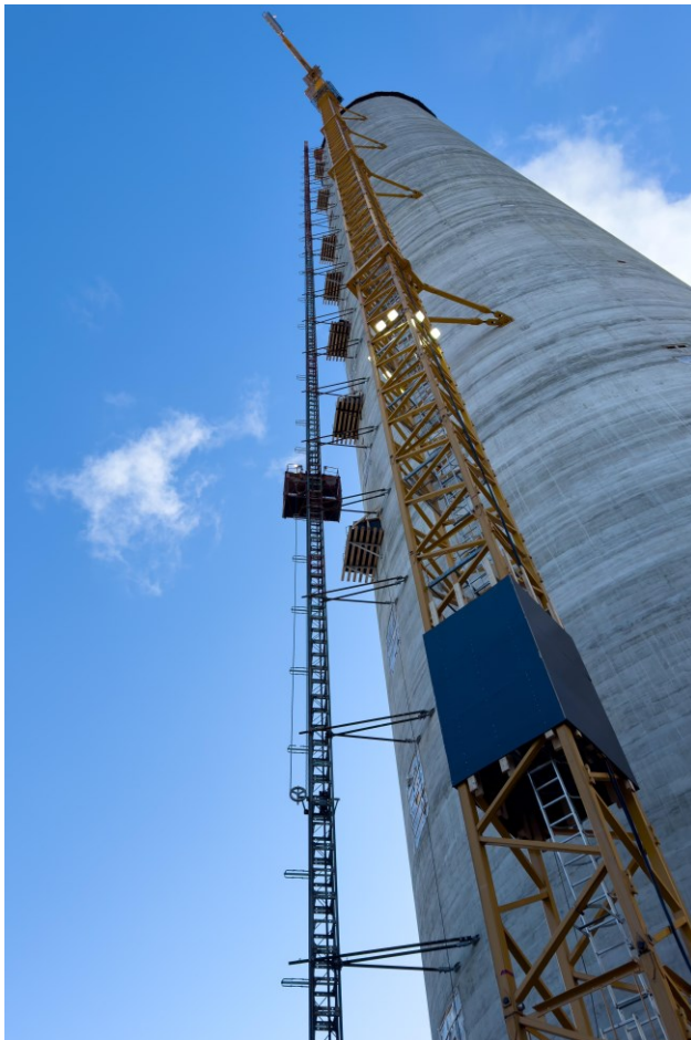
Kuva 19. Alimak-henkilötavarahissille rakennettiin uloke kulkusiltaja tornin ikkuna-aukkoihin mahdollistamaan kulkeminen kerroksiin (Kuva Juho Humalainen).
