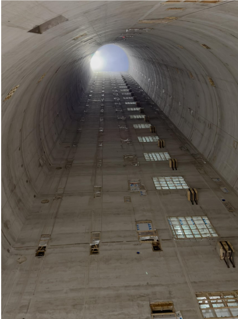
Kuva 13. Liukuvalun valmistuttua tornissa ei ollut vielä vaakarakenteita. Kuva tornin suurimmasta tilasta, prosessitilasta, joihin rakentui myöhemmin tuotantolinja (Kuva Juho Humalainen).
