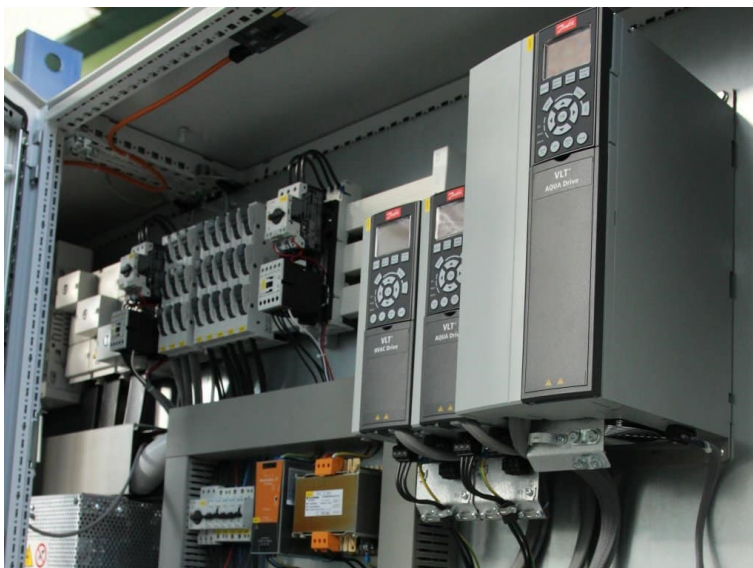
Kuva 1. Koteloinnin sisällä olevia koteloituja sähkölaitteita (3).
