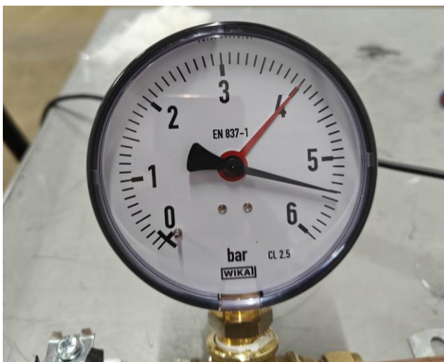
Kuva 7. Vesijohdon maksimipaine (Kuva: Santeri Kuokkanen)
