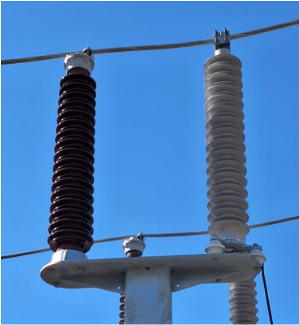
Kuvio 10. Vasemmalla tukieristin tukemassa johtoa ja oikealla ylijännitesuoja
