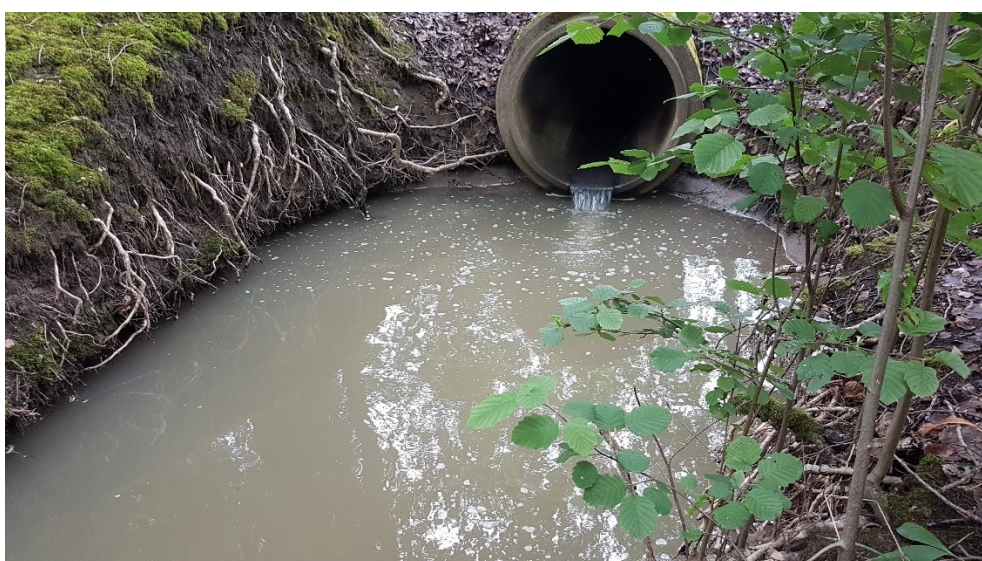
Kuva 7. Hulevesiviemäri Mikonkorven purouoman alkupäässä
