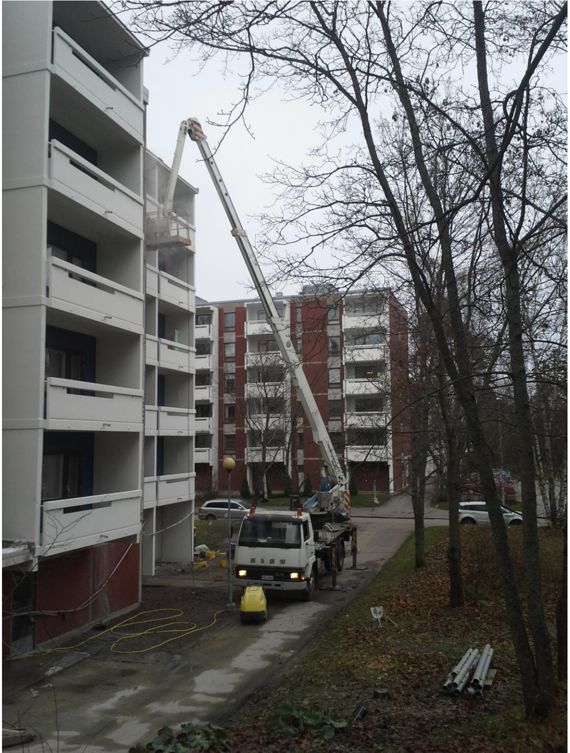
Kuva 1. Henkilönostin pedattu osittain asfaltille ja osittain nurmialueelle.
