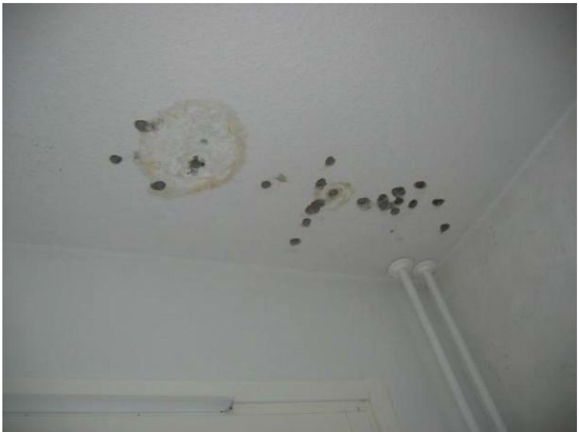
Kuva 8: Katossa ilmennyt vettä ja onteloon on tehty reikiä veden poistamiseksi[13].
