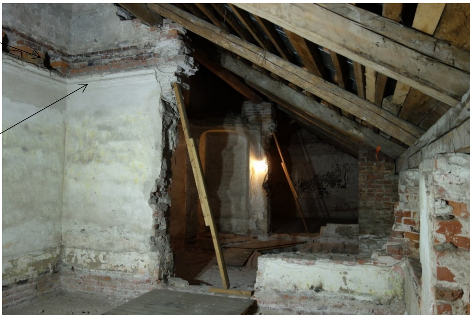
Kuva 29. Huoneiden 305 ja 306 välillä olevat tiiliset väliseinät ovat joko tuhoutuneet Krimin sodassa tai purettu.
