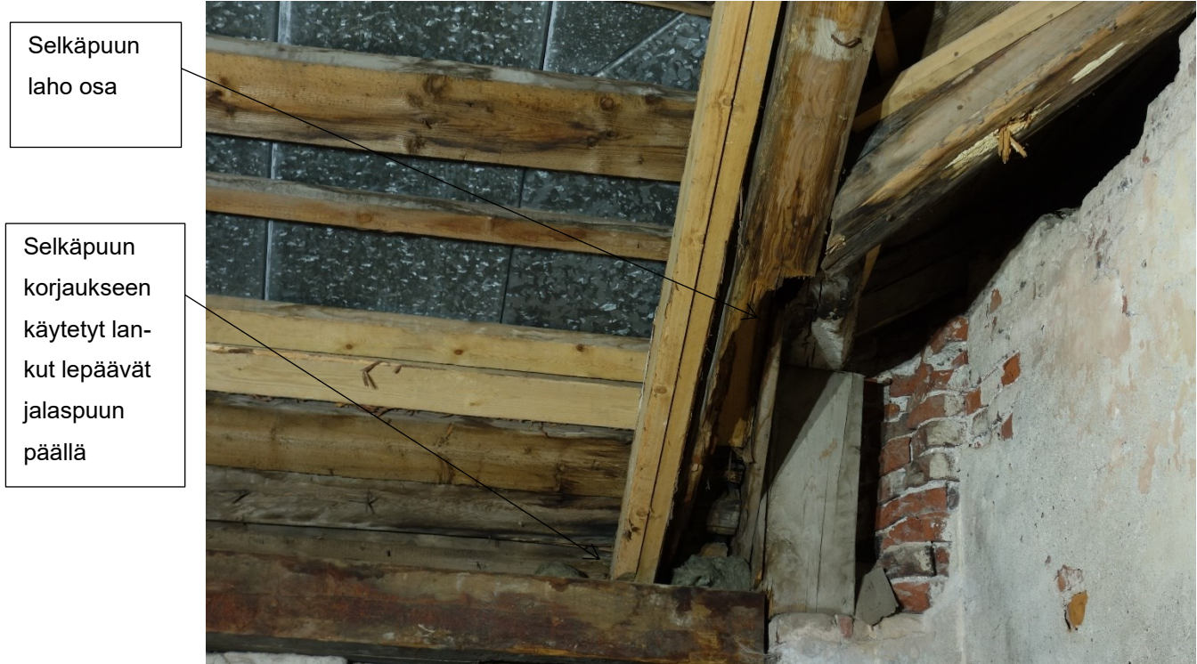
Kuva 57. Selkäpuun lahonnut alaosa on tuettu jalaspuuhun kahden lankun avulla.
