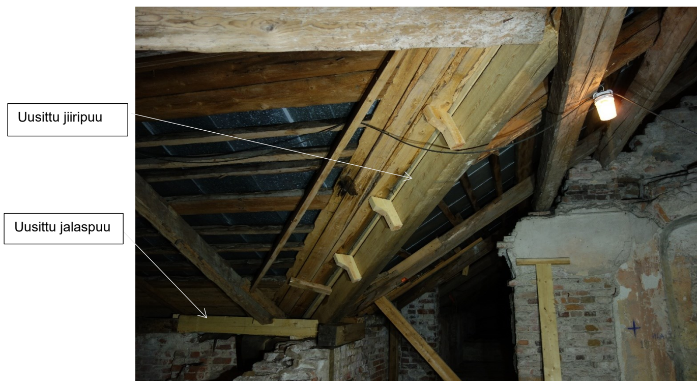
Kuva 55. Käymäläsiiven ja huoneen 305 välisen jiiripuun korjaus. Vanha jiiripuu on poistettu ja korvattu uudella hirrellä.
