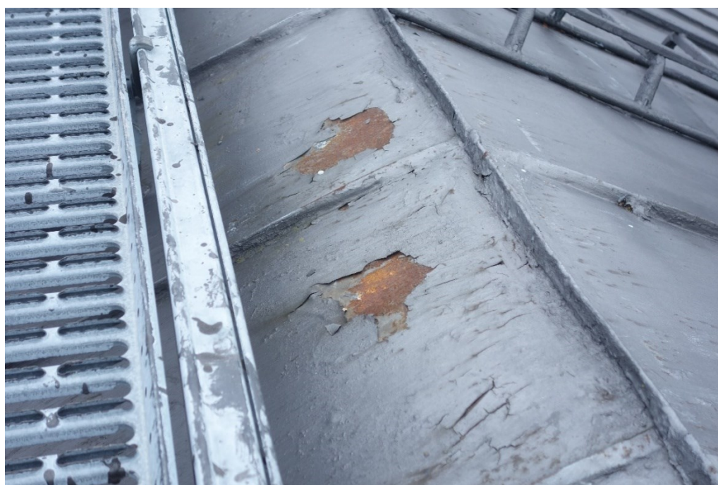
Kuva 62. Vesikaton pinnoitteen vaurioita katon harjan tasalla
