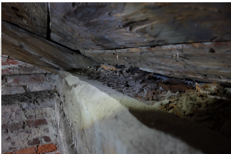
Kuva 75. Huoneessa 312 sijaitseva jalaspuu, joka on ulkosyrjästään täysin laho
