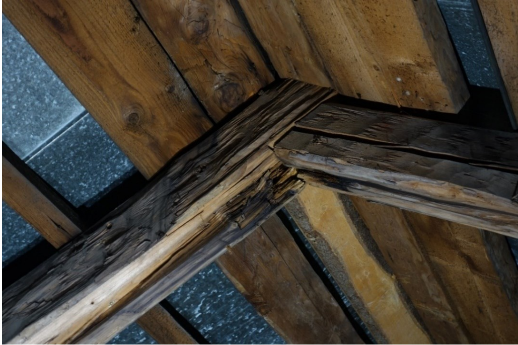
Kuva 73. Selkämpuiden I–14 ja L–14 yläosien lahovaurio
