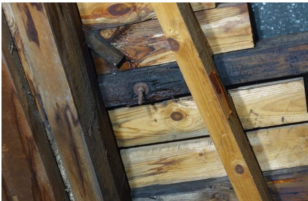
Kuva 59. Ullakolla sijainnut vuotava läpivienti
