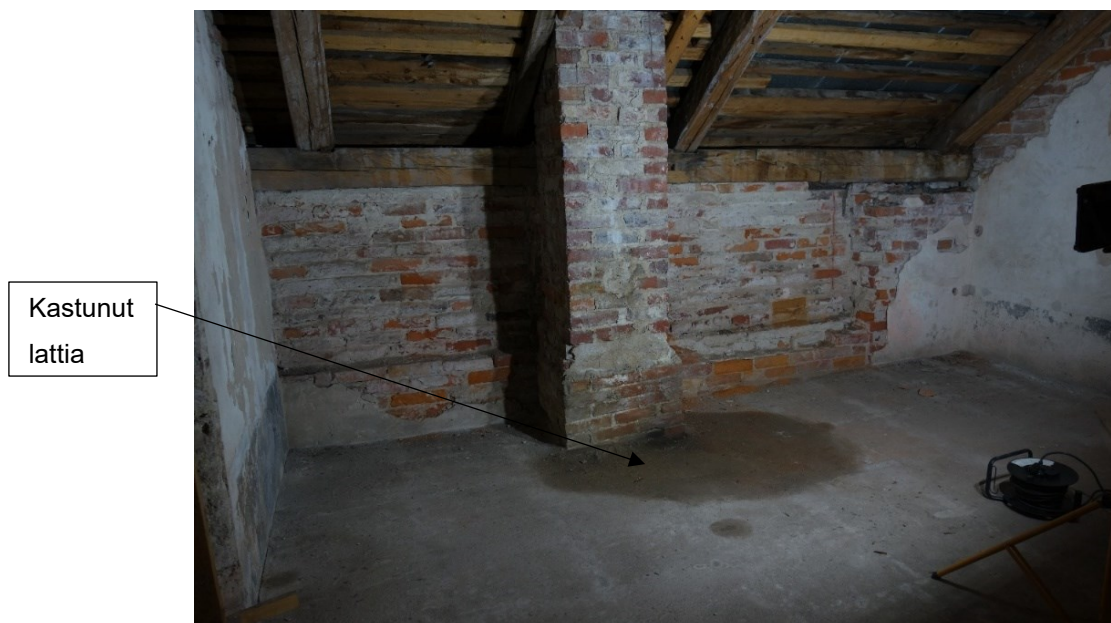
Kuva 67. Huoneessa 304 sijaitsevan hormin vuoto on aiheuttanut lattian kastumisen.
