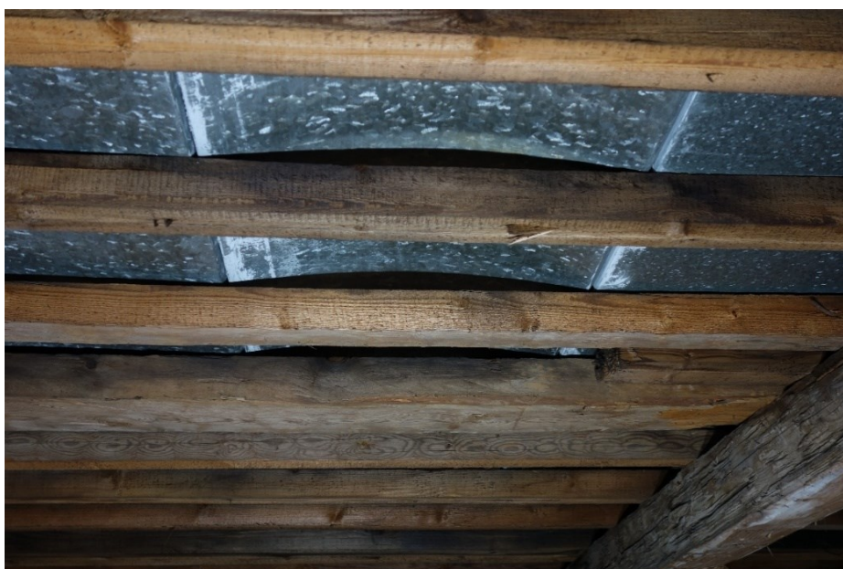
Kuva 68. Huoneessa 315 sijaitseva peltilevy, joka on kaareutunut
