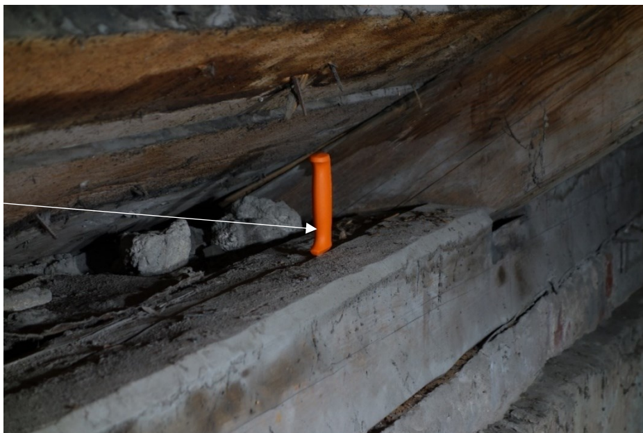
Kuva 74. Huoneessa 319 sijaitseva jalaspuu, joka on sisäosiltaan laho
