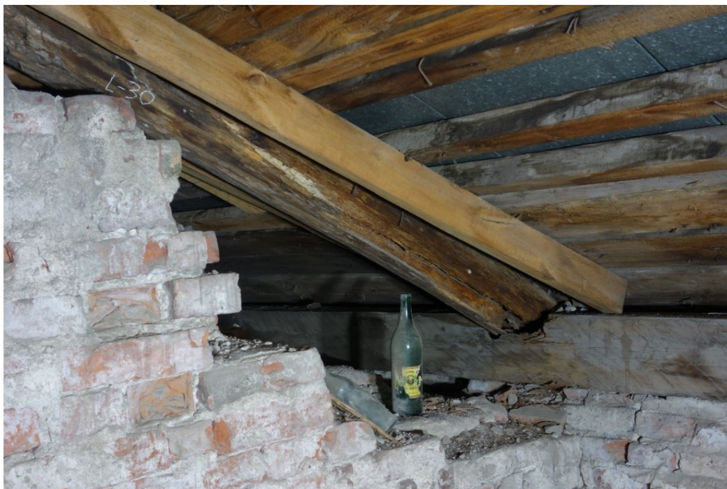
Kuva 71. Selkäpuu L-30, joka on alaosastaan kauttaaltaan laho
