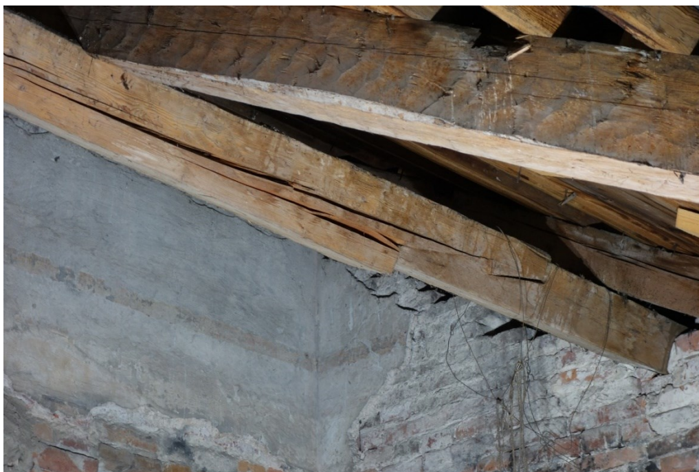
Kuva 79. Huoneessa 307 sijaitseva ankkuripuun on murtunut hakaliitoksen vasemmalta puolelta.
