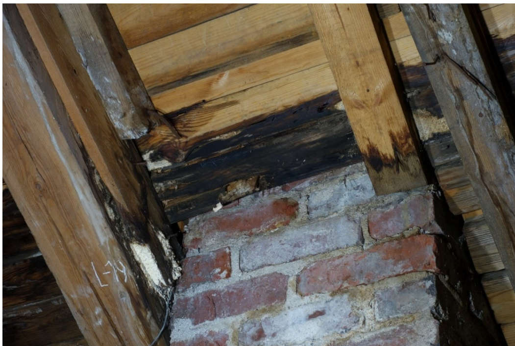
Kuva 81. Huoneessa 306 sijaitseva hormi, jota ympäröivät kattoruoteet ovat lahon haurastuttamat
