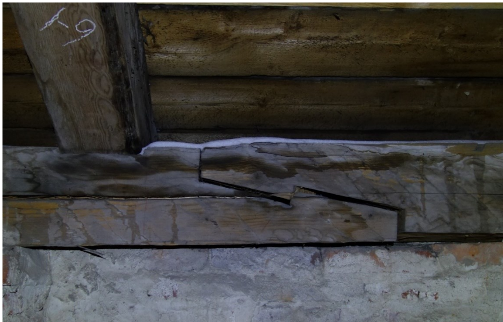
Kuva 76. Huoneessa 313 sijaitseva jalaspuu, jonka päälle on kertynyt lunta
