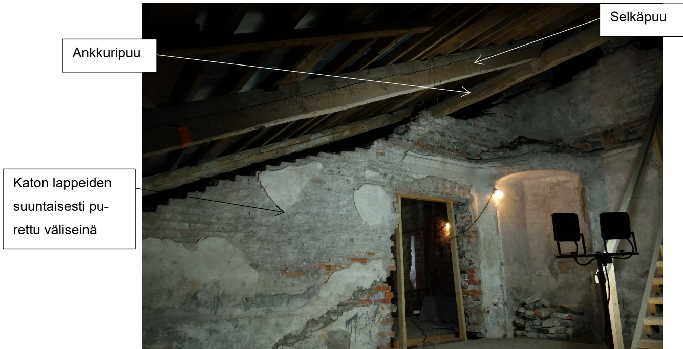
Kuva 36. Huoneiden 311 ja 312 välinen väliseinä on purettu katon lappeen suuntaisesti. Ankkuripuu lepää tiilisen väliseinän varassa, joka kannattelee selkäpuuta.
