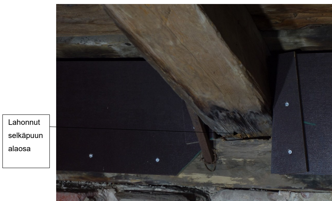
Kuva 70. Selkäpuun l-2 alaosa, joka on lahon haurastuttama
