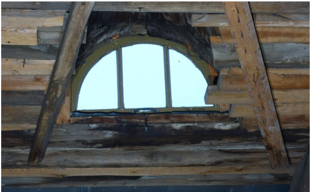
Kuva 80. Huoneessa 311 sijaitseva kattolyhty, jonka alapuoliset ruoteet ovat vettyneet
