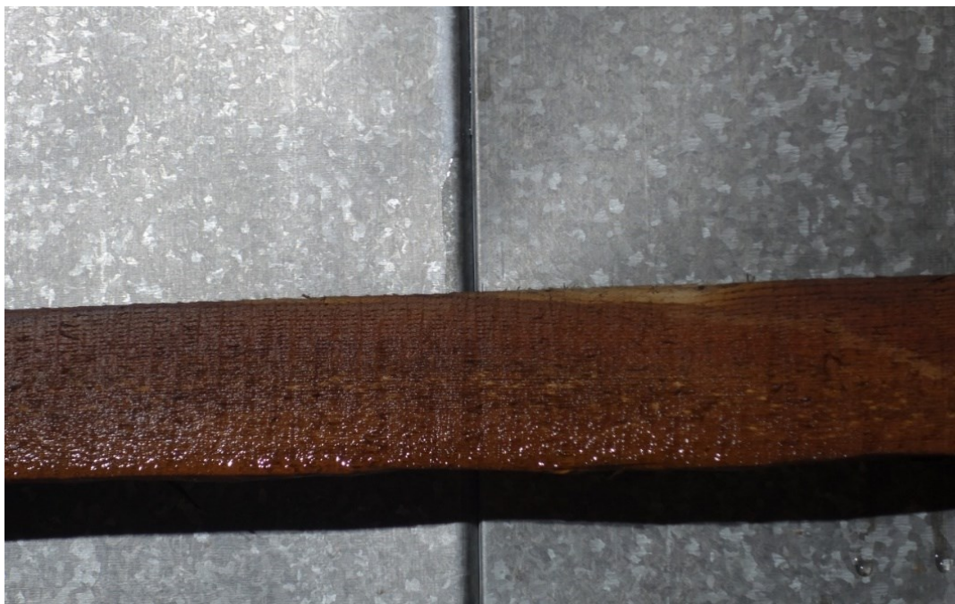
Kuva 65. Huoneessa 316 sijaitseva vettynyt kattoruode
