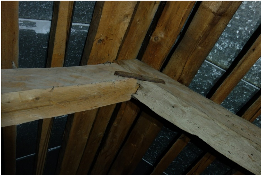
Kuva 39. Selkäpuun yläosien liitos. Liitosta on vahvistettu käyttämällä kulmarautaa.
