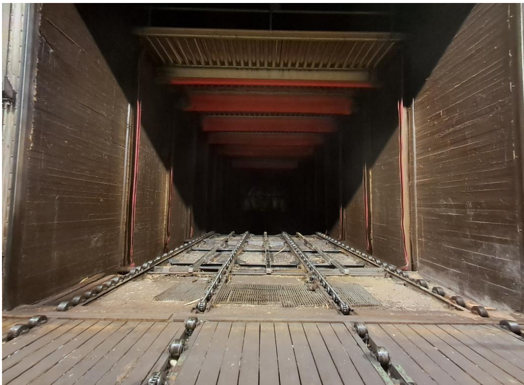
Kuva 5. Näkymä tyhjään 1-vaiheiseen kanavakuivaamoon ulosottopäästä.
