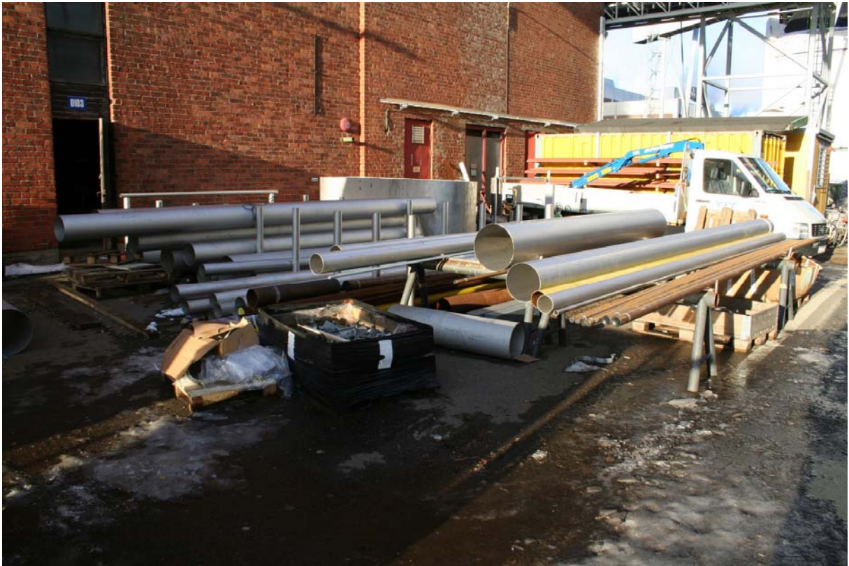
Kuva 1. Putkifakissa putket sekaisin
