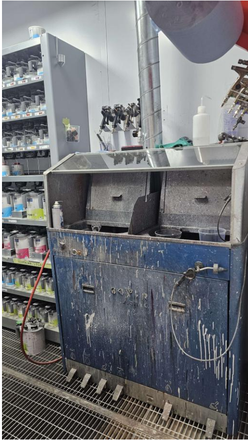
KUVA 3. Maaliruiskujen puhdistuskaappi ja ruiskutelineet.
