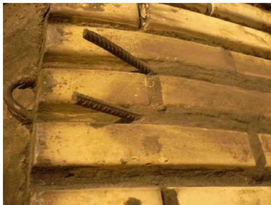
Kuva 18. Kiinnipureutunut hiekka ja harjateräkset
