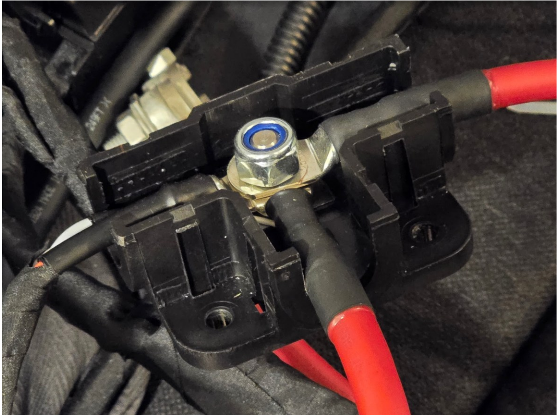
Kuva 10. Johtosarjaan lisätty virranjakopiste.
