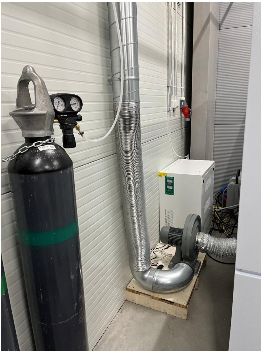
Kuva 5. Savukaasun poistopuhallin putkitettuna.
