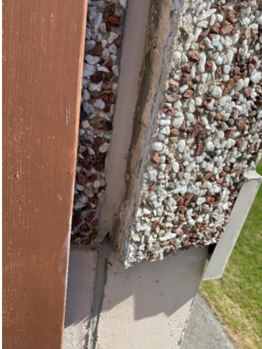
Kuva 11. Elementti vääntynyt rapautumisen seurauksena (Julkisivukonsultointi 2024).
