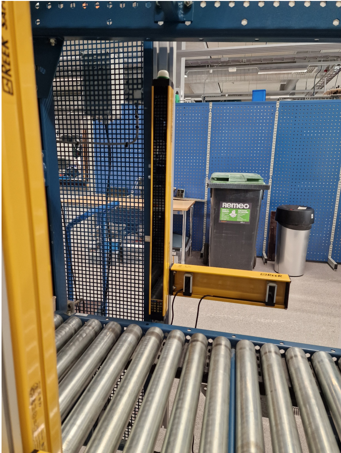
Kuva 1.2. Asennettu valoverhovastaanotin ja muting.
