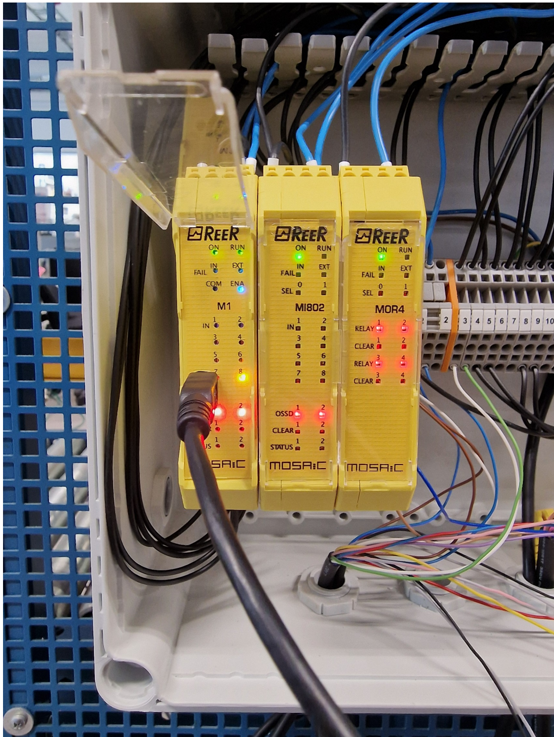
Kuva 1.4. Päällä oleva PLC
