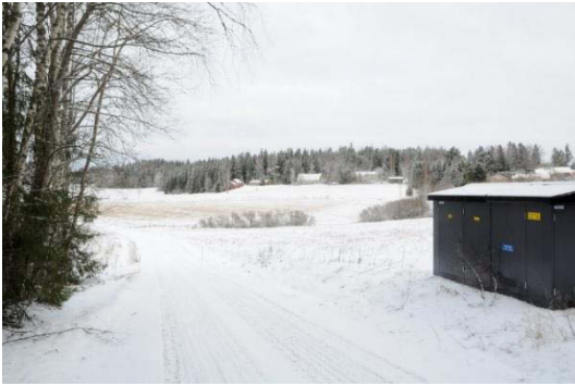
Kuva 41. Sähkökeskus Aittakalliontie varressa, kuva otettu Ait- takalliontieltä kohti pohjoista. Kuvassa vasemmalla riihelle joh- tava liittymä.
