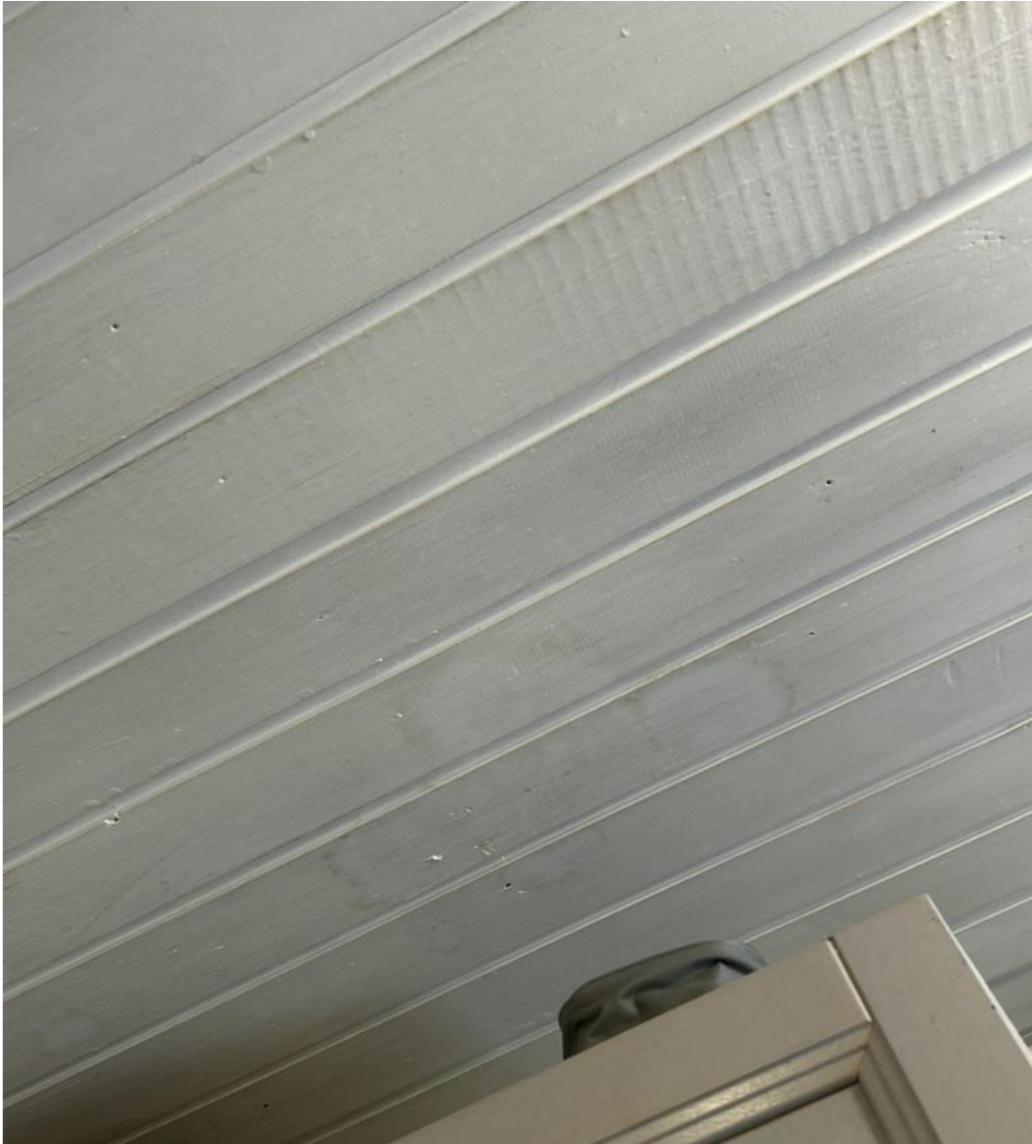
KUVA 42. Kosteusvaurio kylpyhuoneen katossa.
