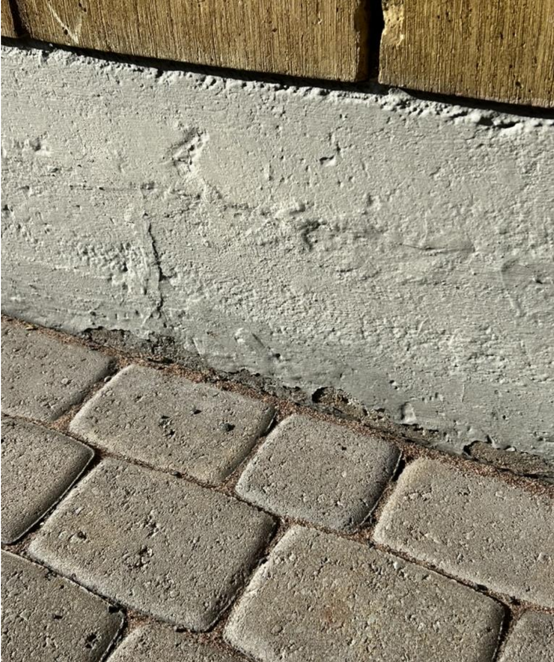
KUVA 28. Sokkelin kulunut maalipinta.
