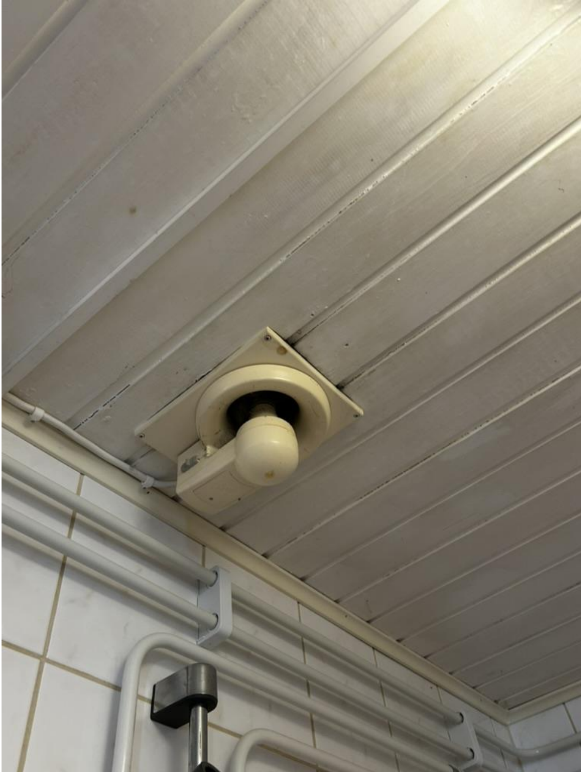
KUVA 41. Kylpyhuoneen ilmastointiventtiili ja lisäilmanvaihto tuuletin.
