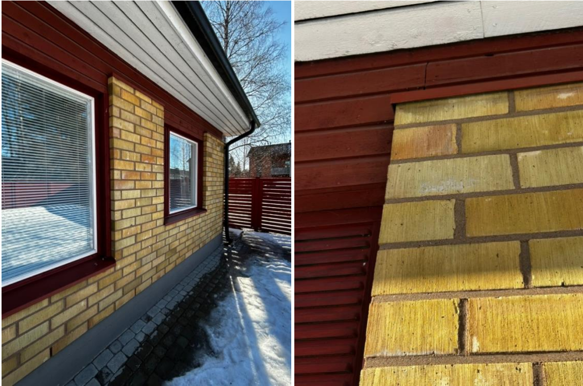
KUVA 20. Talon julkisivu ja vesipellin kohdalta tummunut tiili.
