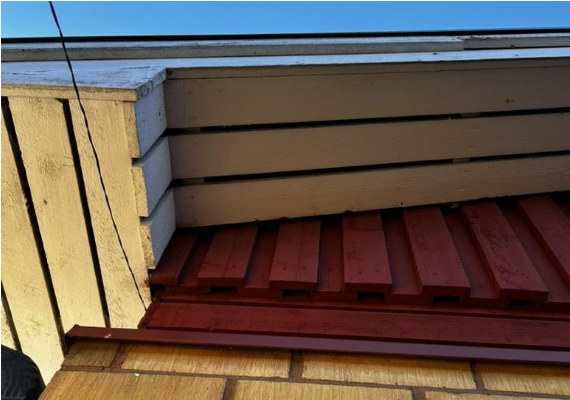
KUVA 44. Pieneläimet pääsevät lautojen välistä ullakolle.
