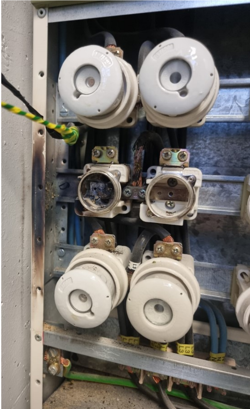
Kuva 2. Varokepesän ja johtimen vaurioita.
