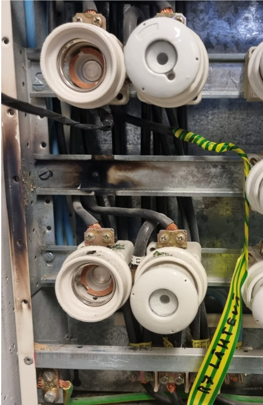
Kuva 3. DIN-kiskoon jäänyt palojälki.
