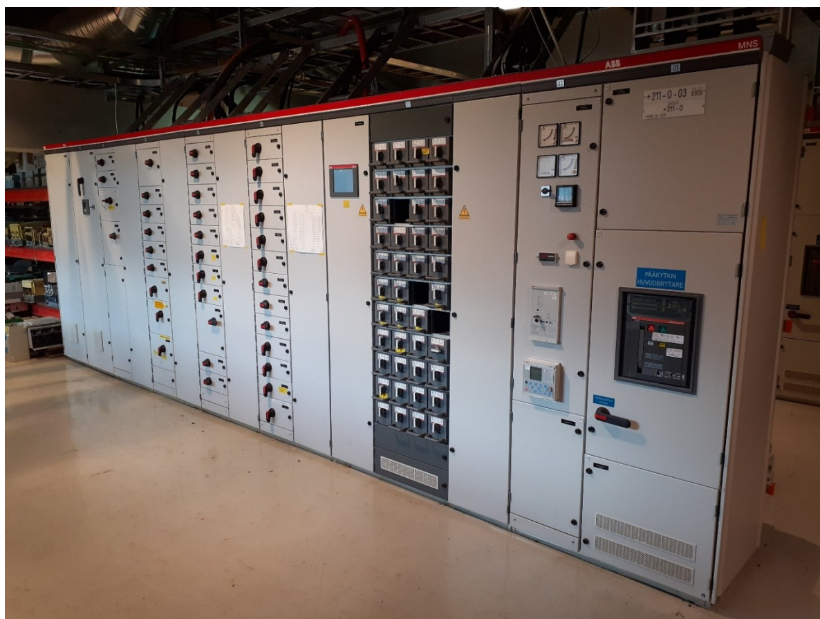
Kuva 15. ABB MNS Keskus O-pääkeskustilassa. (Kipinoinen 2025)
