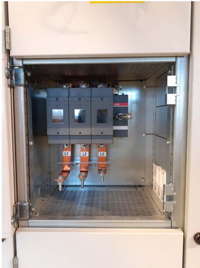
Kuva 20. Vapaa sulakelähtökotelo ja kytkinvaroke ABB MNS-keskuksella. (Kipinoinen 2025)
