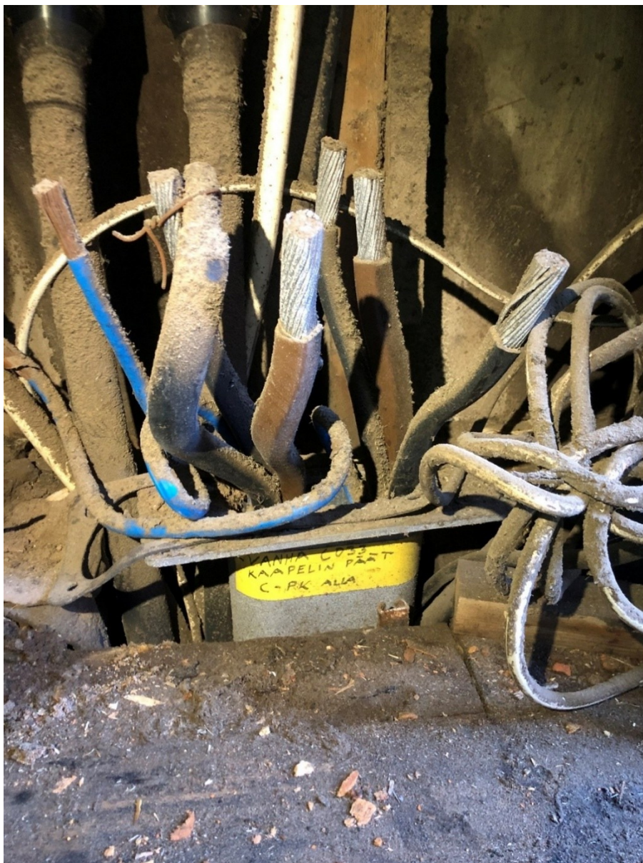
Kuva 12. Kaapeleiden päät pääkuorimakoneen rakennuksessa. (Kipinoinen 2025)
