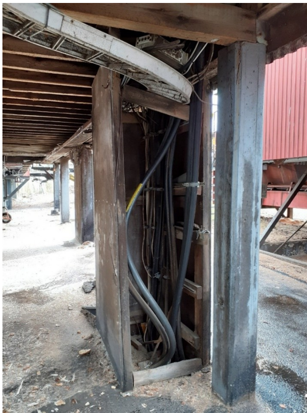
Kuva 13. Kaapeleiden nousukohta pääkuorimakoneen rakennukseen. (Kipinoinen 2025)
