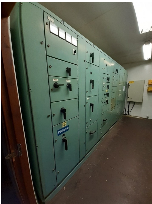
Kuva 14. Varakuorimakoneen keskus ja takana suunnanvaihtokontaktorien kotelo. (Kipinoinen 2025)
