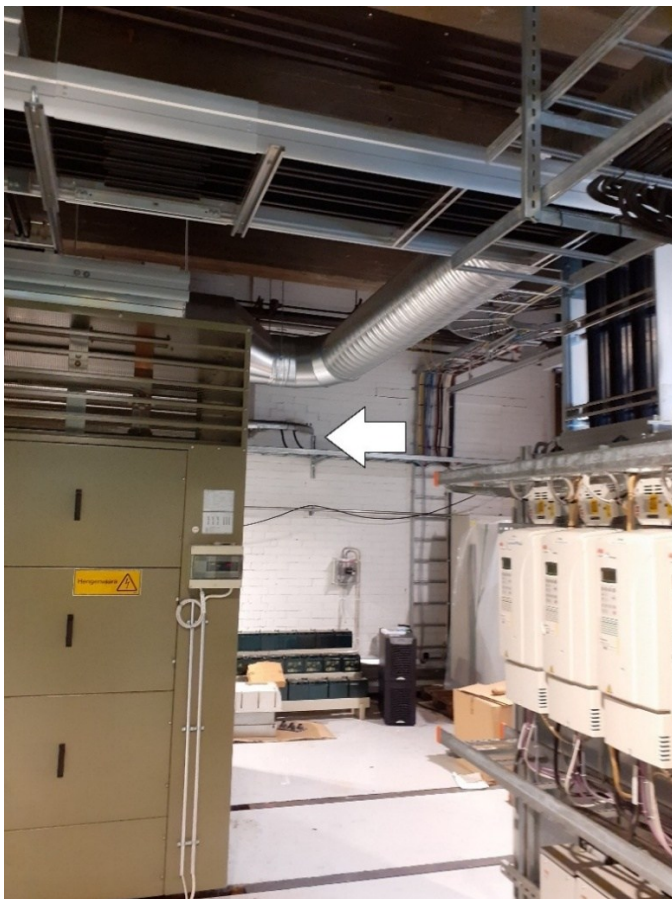
Kuva 18. Kaapeleiden läpivientikohta O-päätokeskustilassa (Kipinoinen 2025)
