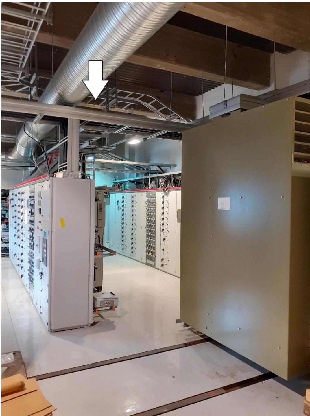
Kuva 19. Kaapelihyllyn lähtöpiste ja oikealla muuntaja. (Kipinoinen 2025)
