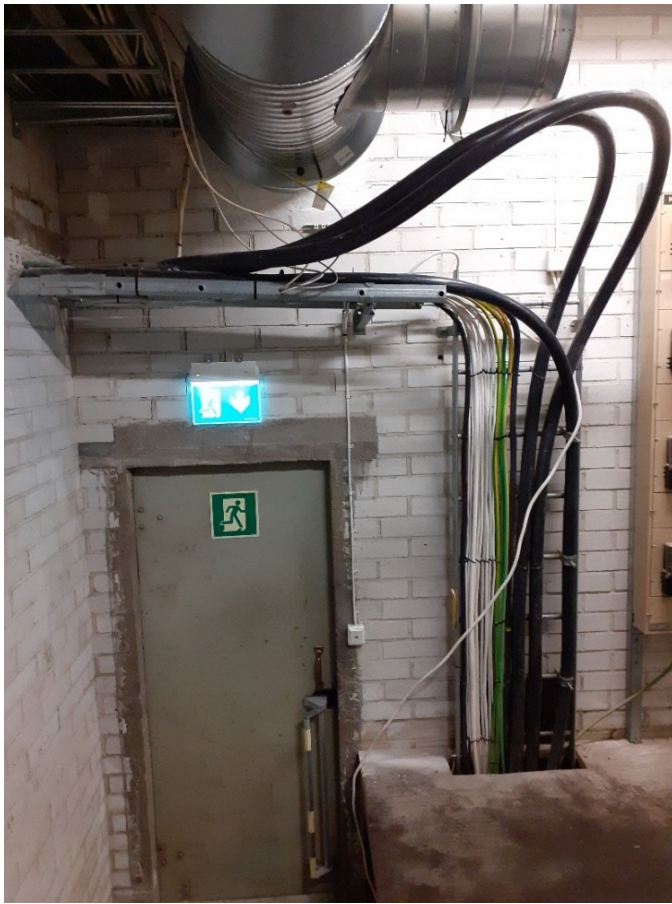
Kuva 17. Kaapeleiden läpivientikohta C-päätokeskustilassa (Kipinoinen 2025)
