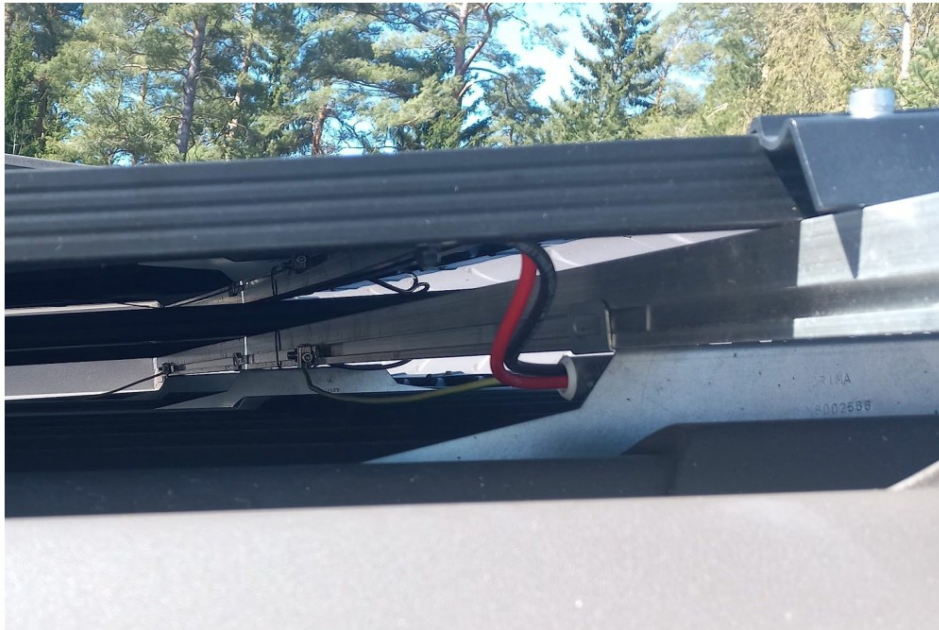
Kuva 9. Tasasähkökaapeli katolle vienti suojattu hienosti japp-putkella jossa putkenpäätte paikoillaan.
