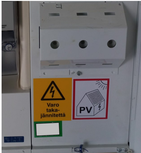
Kuva 1. Takasyöttövaara tarra löytyy pääkeskuksesta. Erotuskytkimensijainti-tarra puuttuu.
