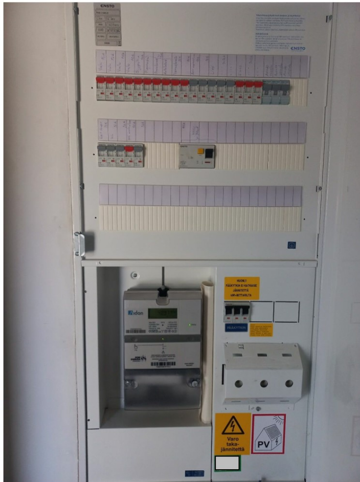
Kuva 4. Pääkeskuksen 50A nimellisvirta on riittävä.
