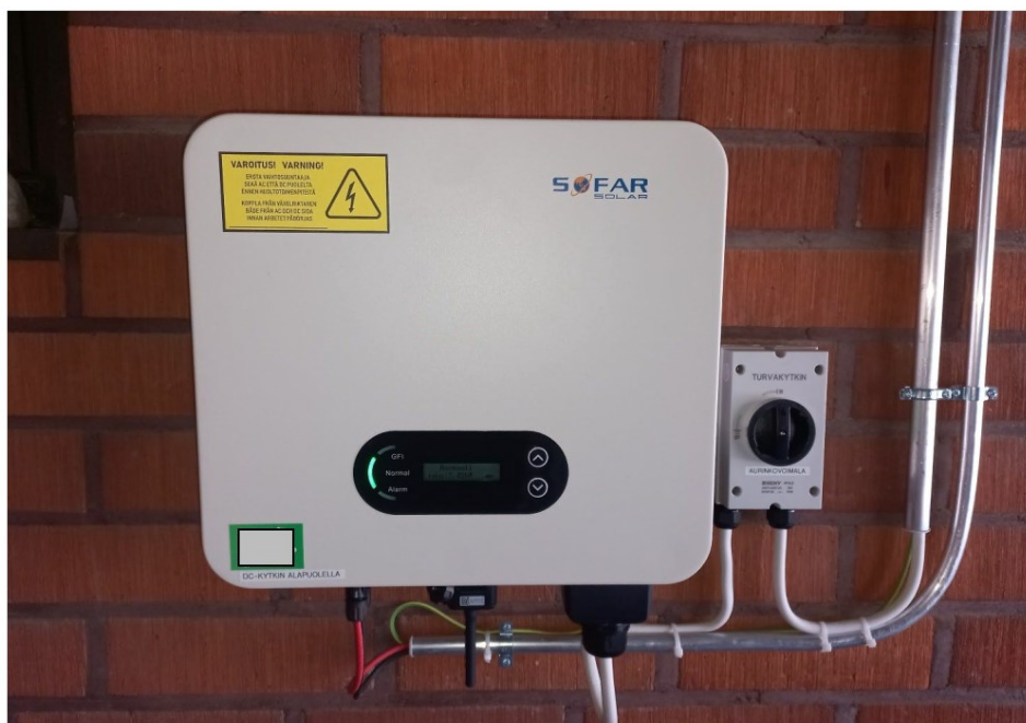
Kuva 2. Invertterissä tarrat paikallaan.
