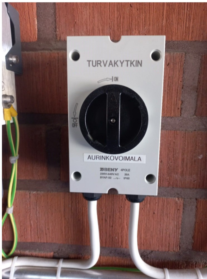
Kuva 6. Vaihtosähköpuolen (AC) erotuskytkin.
