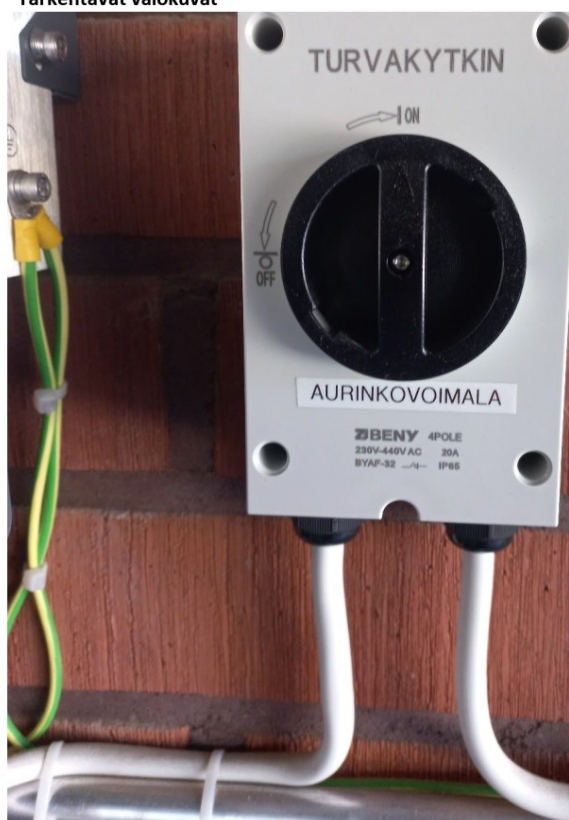
Kuva 11. Invertterin liittäminen potentiaalintasaukseen keltavihreillä potentiaalintasausjohtimilla.
