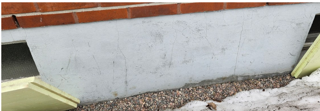
Kuva 8. Esimerkkikuva millaisia halkeamia talon sokkelissa voi olla jo ennestään.
