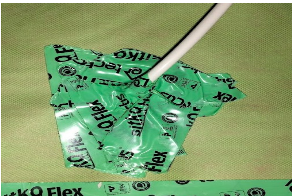
Kuva 9. Sähköjohtojen läpivienti tiivistetty teipillä.
