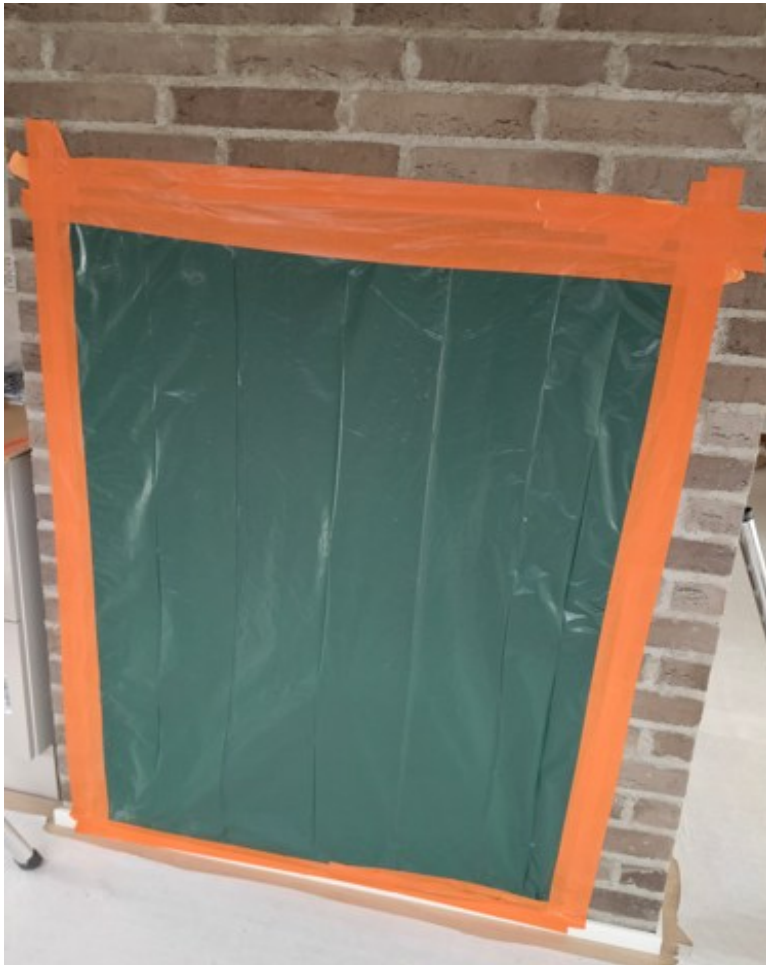
Kuva 16. Tulisijan luukut varmistettu muovilla ja teipillä.
